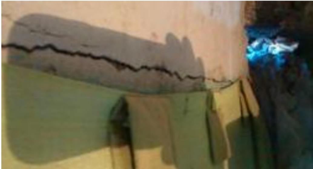
Foto 4: Casa abalada estruturalmente por conta das obras do PAC. Fonte: RELATÓRIO PAC MANGUINHOS: PROBLEMAS NÃO RESOLVIDOS E RECOMENDAÇÕES, 2016. Disponível em < https://bit.ly/2j0BFZ4 >
