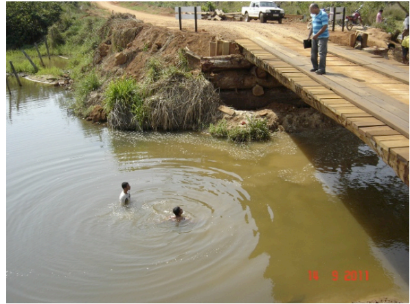
Figura 6: Retirada de recipientes submersos no rio. Observa-se que as pessoas envolvidas no trabalho de retirada não utilizavam equipamentos de proteção.
