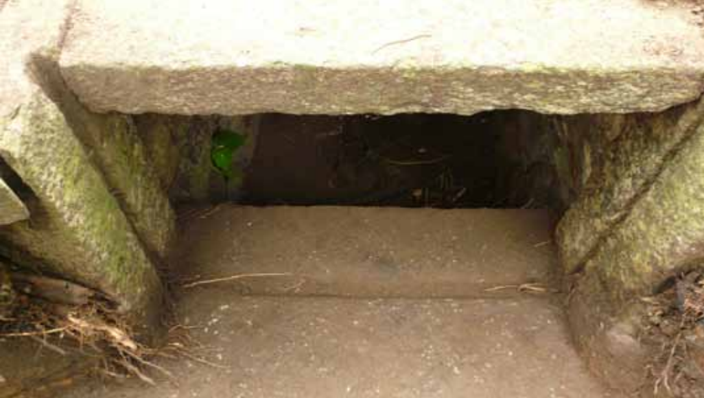
Ladrão de água com sistema de comporta simples no pequeno reservatório.
