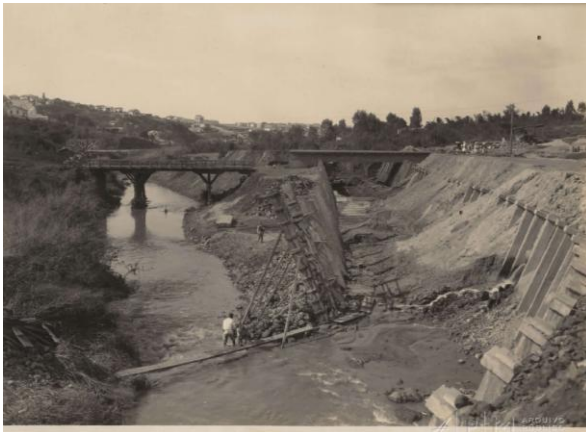
Figura 9: Canalização do ribeirão Arrudas no cruzamento com a Avenida do Contorno - BH, na segunda metade da década de 20. - Fonte: MG - Acervo Arquivo Público Mineiro Notação: OM-2-003(7).
