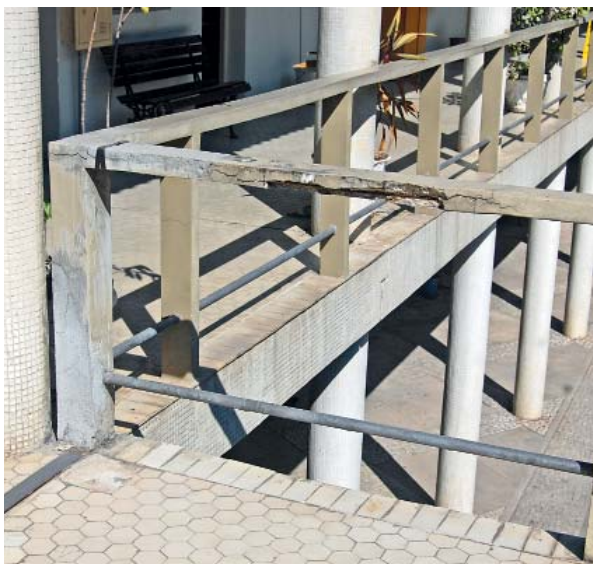
24 – Na imagem pode-se visualizar as perdas de material nos peitoris e montantes do guarda-corpo – The image shows the missing material from the handrail and railings of the guardrail
