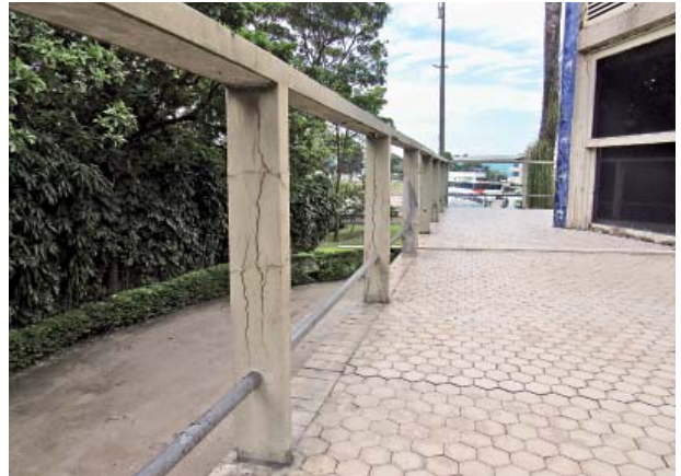
30 – Fissuras nos montantes do guarda-corpo – Cracks in the guardrail stiles
