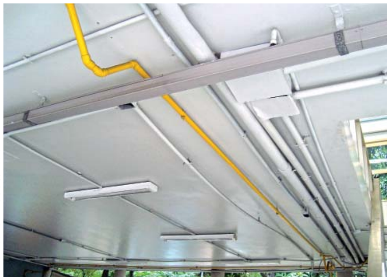
25 – Instalações aparentes percorrendo tetos nas varandas do primeiro pavimento – Visible installations on the first floor veranda ceilings
