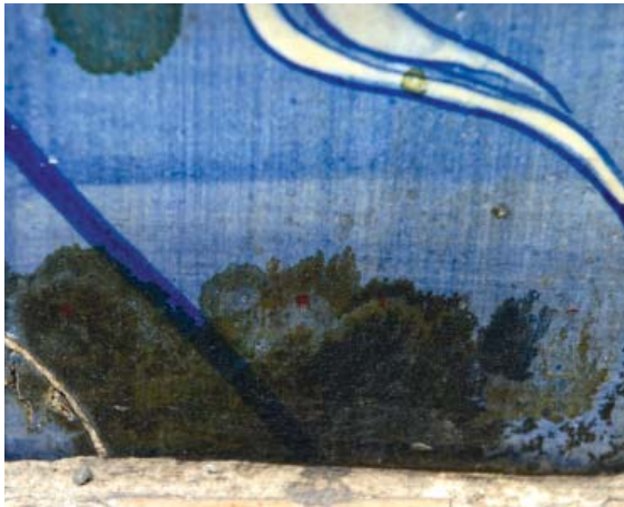
37 – Infestação de fungos – Fungal infestation
