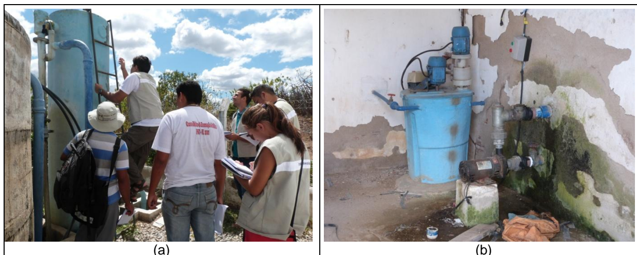
Figura 74. Inspeção na Estação de Tratamento de Água de Quieto. (a) Filtro colmatado sem manutenção. (b) Aparelhos de coagulação e floculação avariados e desativados.
