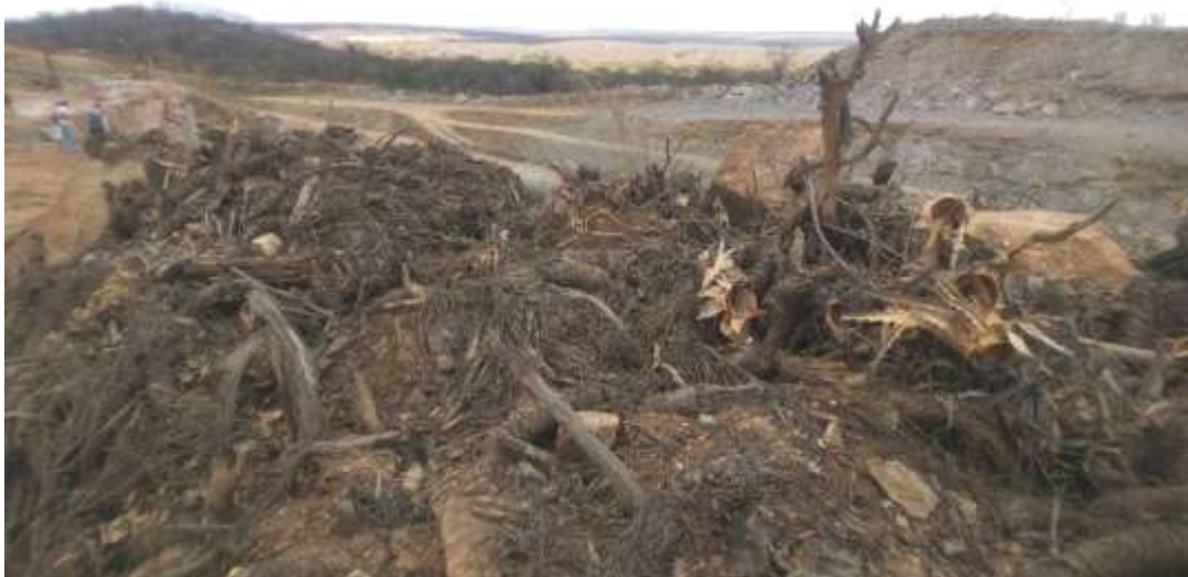
Fotografia 15 – Destruição e desmatamento da caatinga para a construção do Eixo Leste da transposição do rio São Francisco, Aldeia Caraibas, Floresta/PE, 2014
