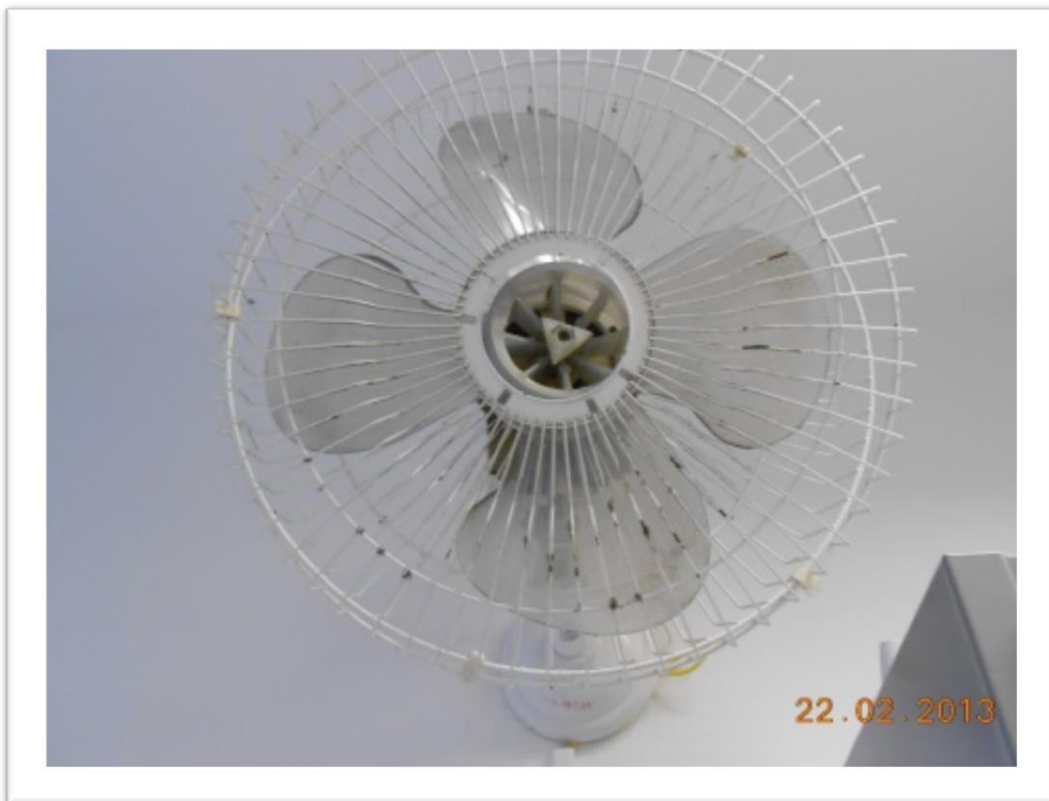
Figura 35 – Ventilador do vestiário
