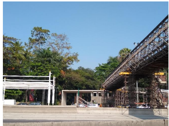
Figura 56 Portaria da Av. Brasil: passarela provisória e obra paralisada do BRT afetam a visibilidade da portaria, 2018. Foto: Rosana Zouain.
