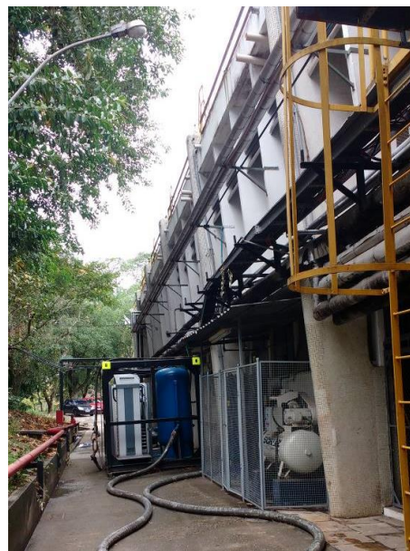
Figura 83 Laboratório da Febre Amarela: equipamentos instalados próximos à fachada posterior, 2016. Foto: Rosana Zouain
