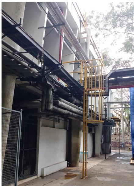
Figura 82 Laboratório da Febre Amarela: fachada posterior com diversas tubulações aparentes, 2016. Foto: Rosana Zouain
