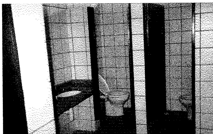
Foto 3 – Banheiro da Escola de Educação Especial
