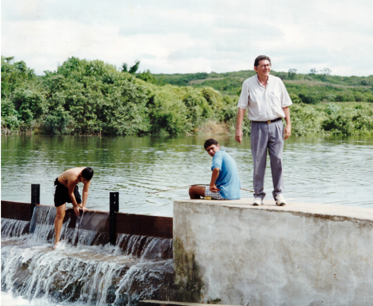
Conclusão da barragem autossustentável com soleira móvel (trilhos e tábuas) no Rio Jaguaribe - projeto de Hypérides Macêdo e Ivan Macêdo (Jucás/CE, 1996)
