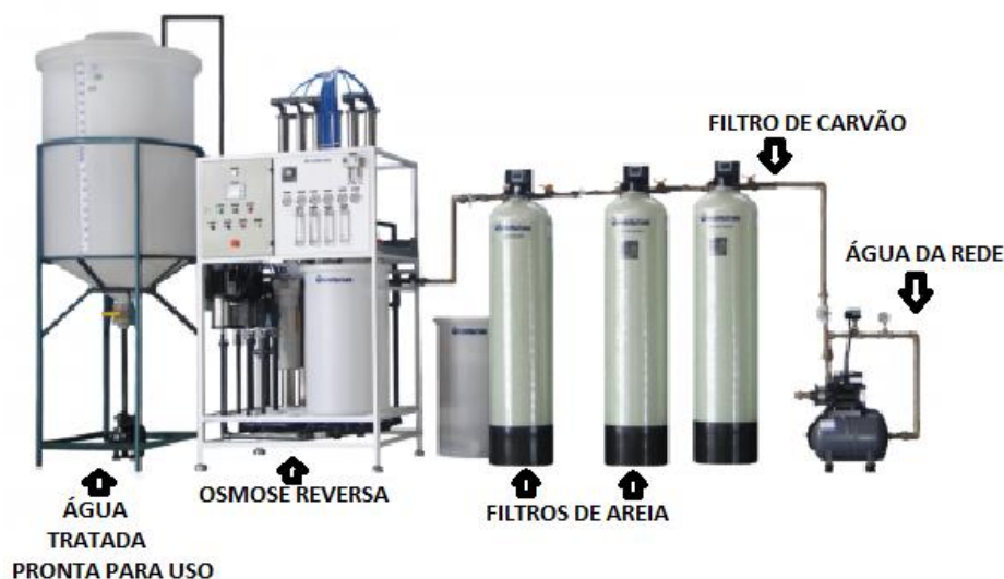
Figura 4- Sistema de tratamento de água dos serviços de hemodiálise realizados em clínicas
