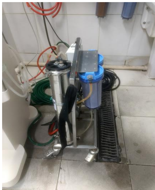
Figura 11 – Aparelho de osmose portátil ligado à rede de distribuição de água em área de expurgo de unidade de tratamento intensivo hospitalar
