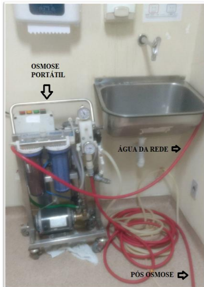
Figura 10 – Aparelho de osmose portátil conectado a uma torneira na antessala de uma unidade de tratamento intensivo hospitalar
