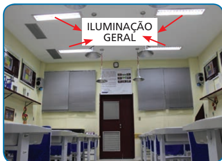
Foto 2 – Sistema de iluminação geral
