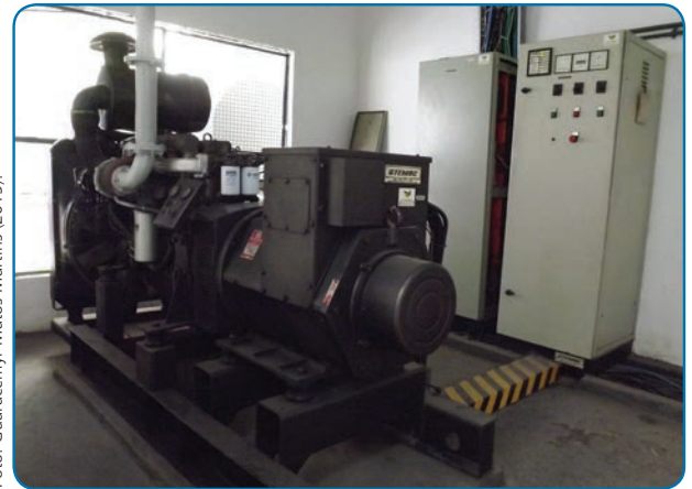
Foto 5 – Sistema de gerador de energia da Cenadi
