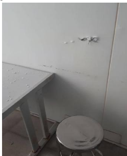
Fotografia 6 - parede de um consultório da eSF atingida por projétil de arma de fogo durante tiroteio
