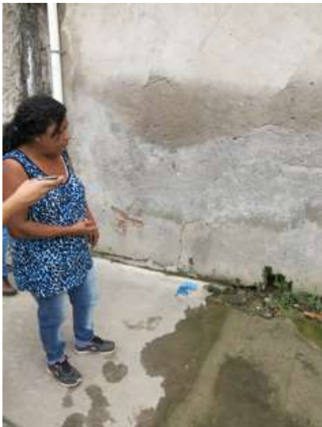
Figura I.2.2 - Fachada da casa de D. Geralda. Vazamento, por baixo da casa, que surgiu depois das obras do PAC na rua São Daniel. Março, 2016. Acervo: Projeto Arquetando Intersubjetividades - Unisuam.
