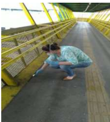
Figura 15: Poeira e fezes de pombo presentes na Passarela para pedestres na Zona Centro-Sul.
