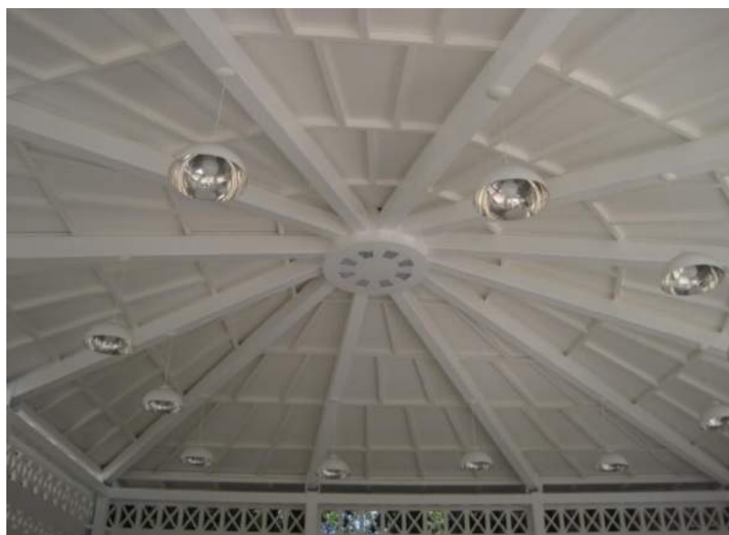
FIGURA 37 – Parte interna da estrutura mista (madeira e metal) com acabamento em esmalte sintético. Fonte: Arquivo DPH, 2011.
