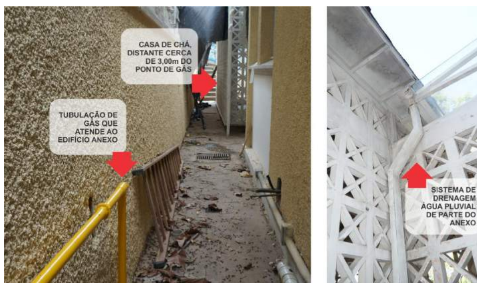
FIGURA 49 – Fotocomposição onde é possível ver a proximidade da tubulação de gás que atende o anexo e a drenagem das águas pluviais de uma parte comum a edificação principal e o anexo. Fonte: Autor, 2019.
