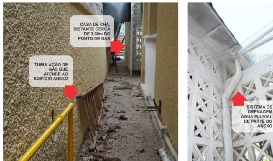
FIGURA 17 – Fotocomposição onde é possível ver a proximidade da tubulação de gás que atende o anexo e a drenagem das águas pluviais de uma parte comum a edificação principal e o anexo. Fonte: Autor, 2019.
