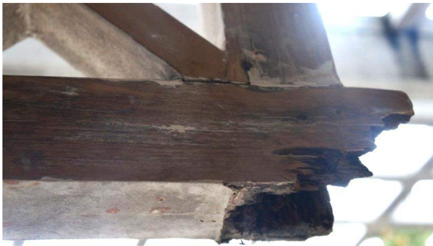
Figura 38– Patologia encontrada, lacuna, perda do pináculo do Painel 02. Fonte: Autor 2018.
