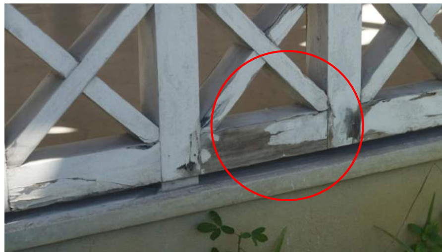
Figura 27– Desplacamento da pintura, Painei 06. Fonte: Autor 2018.
