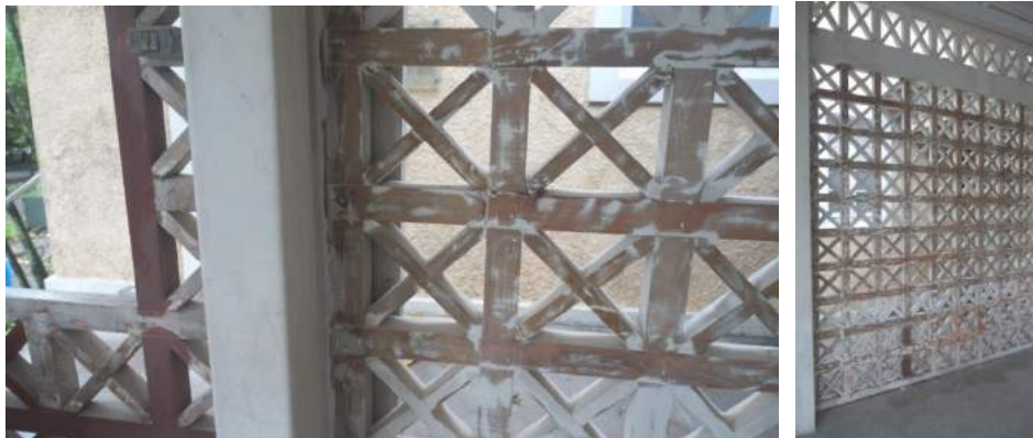
FIGURA 13 - Vista dos painéis que compõem a edificação, lixados ao máximo possível, com a finalidade de expor a madeira ao natural. Fonte: Autor, 2018.
