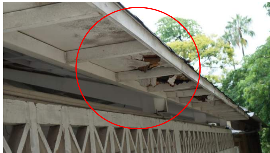
Figura 25– Forro do beiral, na área do Painel 07, com a deformação já bem acentuada. Fonte: Autor 2018.
