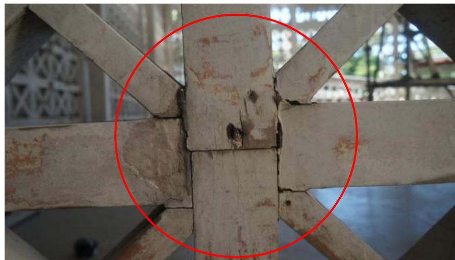
Figura 28– Trincas ou fissuras, tanto no revestimento, quanto na peça de madeira, Painei 08. Fonte: Autor 2018.
