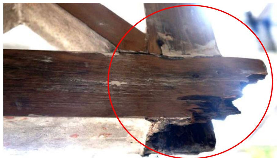
Figura 26– Lacuna, perda do pináculo do Painel 02. Fonte: Autor 2018.
