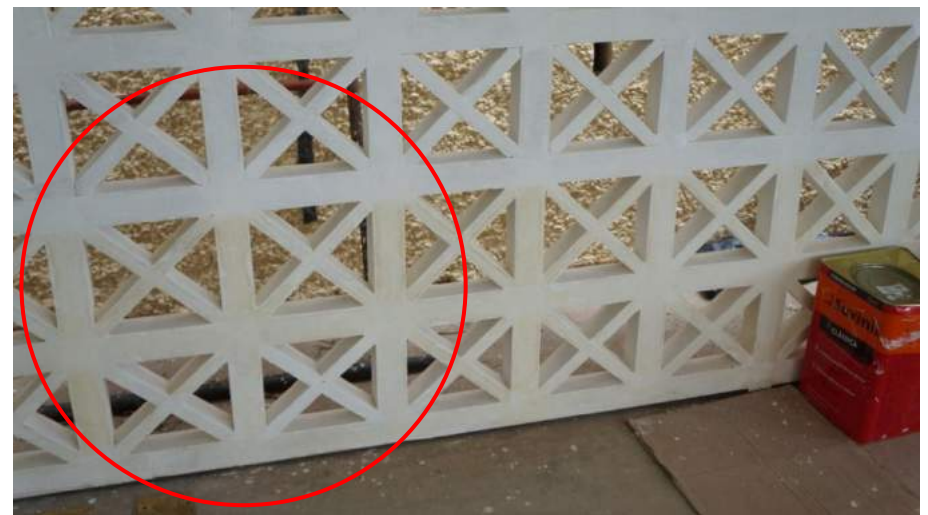
Figura 30 – Mancha de pintura, em função de tinta à base de água, Painel 07. Fonte: Autor 2018.
