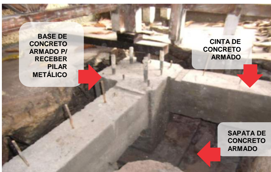
FIGURA 33 – Fundação já pronta, onde é possível ver os conectores da laje de piso e os parafusos de ancoragem dos pilares metálicos. Fonte: Arquivo DPH, 2010
