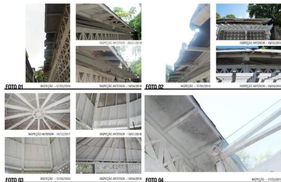
FIGURA 37- Ficha de inspeção do telhado/forro, folha 4 de 4. Fonte: Autor, 2019, baseado na publicação “Metodologia e tecnologia na área de manutenção e conservação de bens edificados: O caso do Núcleo Arquitetônico Histórico de Manginhos, 2009”.
