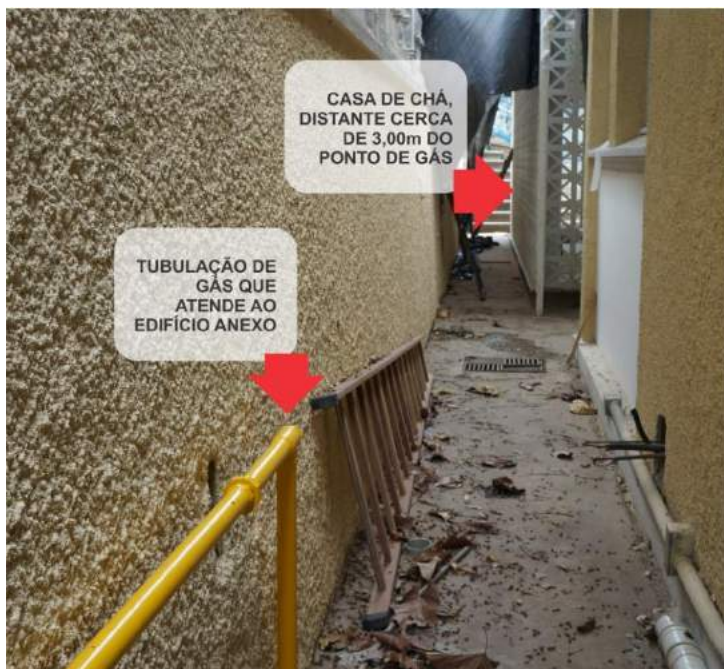
FIGURA 44 – Foto da proximidade da tubulação de gás. Fonte: Autor, 2019.
