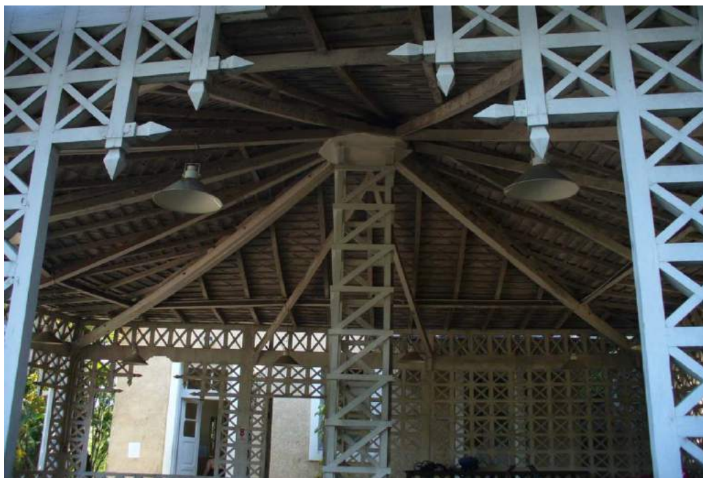
FIGURA 10 - Vista interna onde é possível ver o escoramento no ponto central da cobertura. Fonte: Acervo DAD/FIOCRUZ.
