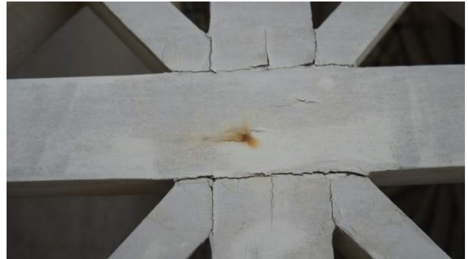
Figura 29 – Mancha devido à oxidação de pregos, Painel 06. Fonte: Autor 2018.
