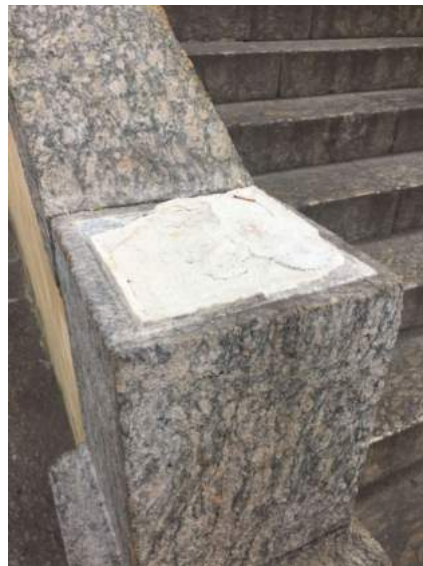
Figura 115. Exemplo de mau uso da edificação. Fonte: Arquivo pessoal.
