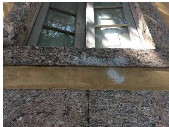
Figura 121. Exemplo de mau uso da edificação. Fonte: Arquivo pessoal.
