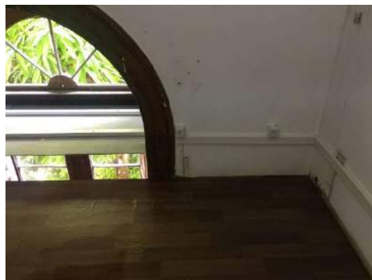
Figura 105. Vista da janela com visão obstruída pelo piso do mezanino e com suporte para ar condicionado. Fonte: Arquivo Pessoal
