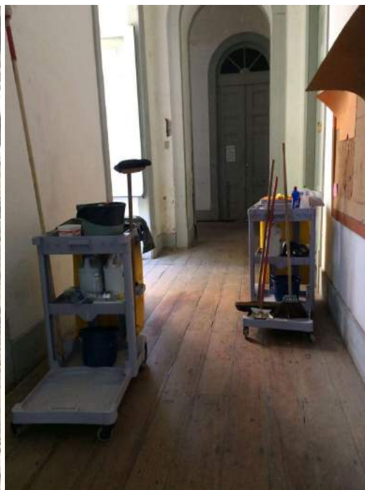
Figura 117. Exemplo de mau uso da edificação. Fonte: Arquivo pessoal.
