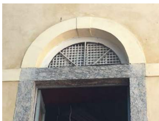
Figura 109. Intervenções em vãos de janelas para instalação de aparelhos de ar condicionado. Fonte: Arquivo Pessoal
