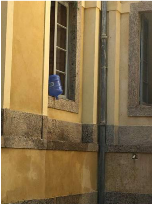
Figura 118. Exemplo de mau uso da edificação. Fonte: Arquivo pessoal.
