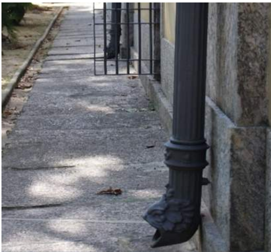
Figura 65. Tubulações de águas pluviais e portões dos porões em ferro fundido. Fonte: Arquivo pessoal
