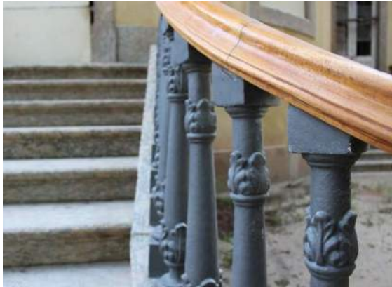
Figura 63. Guarda-corpo da Capela Fonte: Arquivo pessoal
