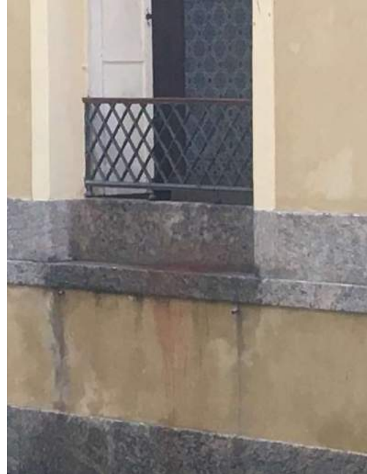
Figura 119. Exemplo de mau uso da edificação. Fonte: Arquivo pessoal.
