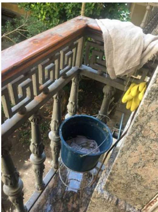
Figura 116. Exemplo de mau uso da edificação. Fonte: Arquivo pessoal.
