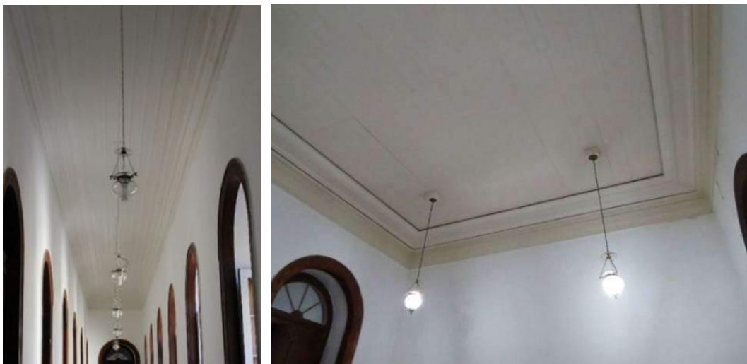
Figura 90 e 91. Forros em madeira, corredores e salas do 2º pavimento. Fonte: ETU/ UFRJ.
