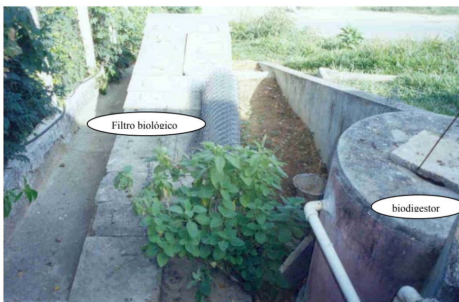
FOTO 1 biodigestor e filtro anaeróbio
