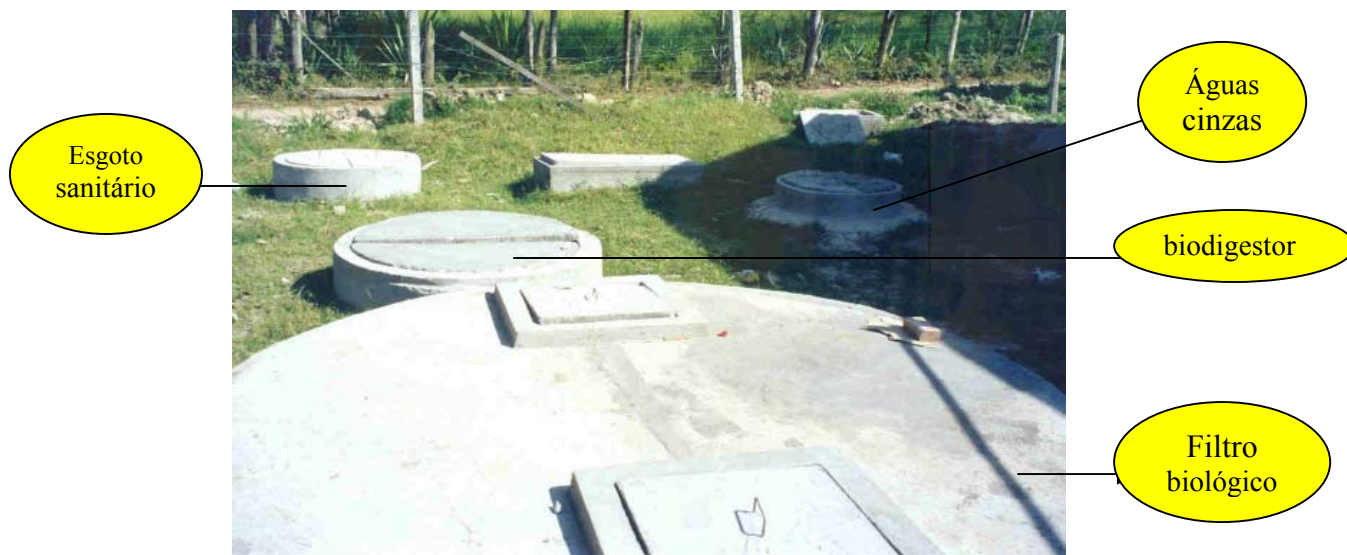
FOTO 7 Filtro biológico para tratamento das águas cinzas e biodigestor para produção de bio-gás.
