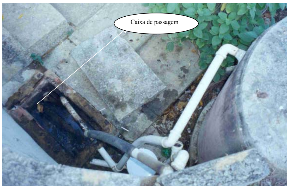
FOTO 2 – Tubos separados para cada tipo de efluente direcionados a caixa de passagem.
