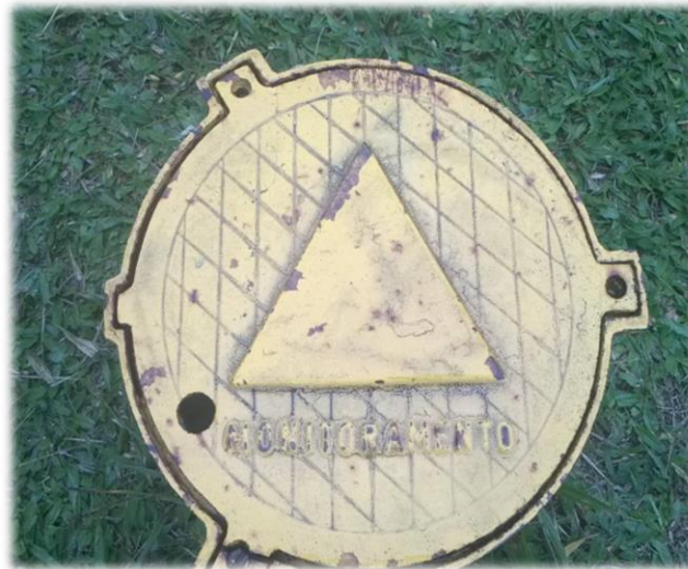
Figura 8: Poços de monitoramento de água subterrânea da CSN
