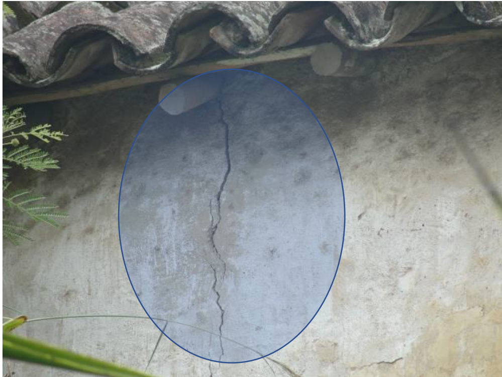
Figura 39 – Detalhe da mesma trinca, que se inicia junto ao telhado.
