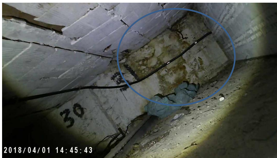
Figura 132 - Imagem de vistoria no entreferro do Pavilhão Mourisco revelando patologia de infiltração.
