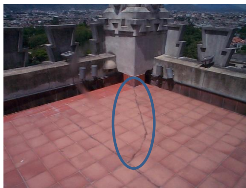
Figura 52 - Fissura no piso de uma edificação histórica.
