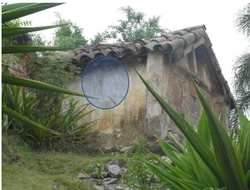
Figura 38 – Trinca vertical, no meio da parede Sudeste 2. Pode indicar possível separação desta ala em relação ao restante da casa e/ou abertura superior da estrutura do telhado.
