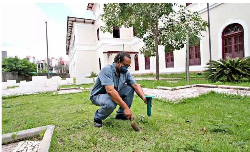
Figura 26 - Técnico instala iscas para cupins no solo: sistema inibe o crescimento do inseto, que morre por inanição, sem agredir o meio ambiente.
