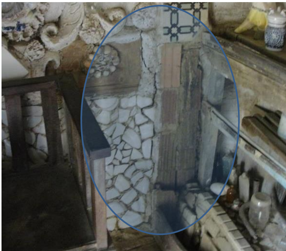
Figura 40 – Trinca manifestada internamente, situada na quina de encontro entre as paredes Sudoeste 2 e Sul 2.
