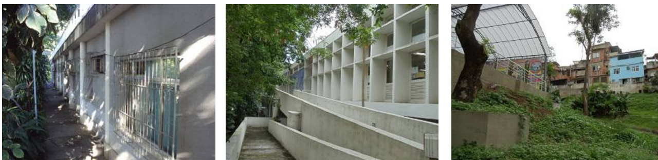
Descaracterizações e interferências negativas sobre o Pavilhão Carlos Augusto da Silva.
