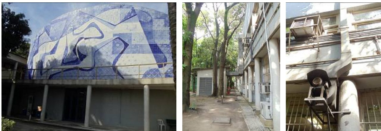
Descaracterizações e interferências nas fachadas do Pavilhão Arthur Neiva.
