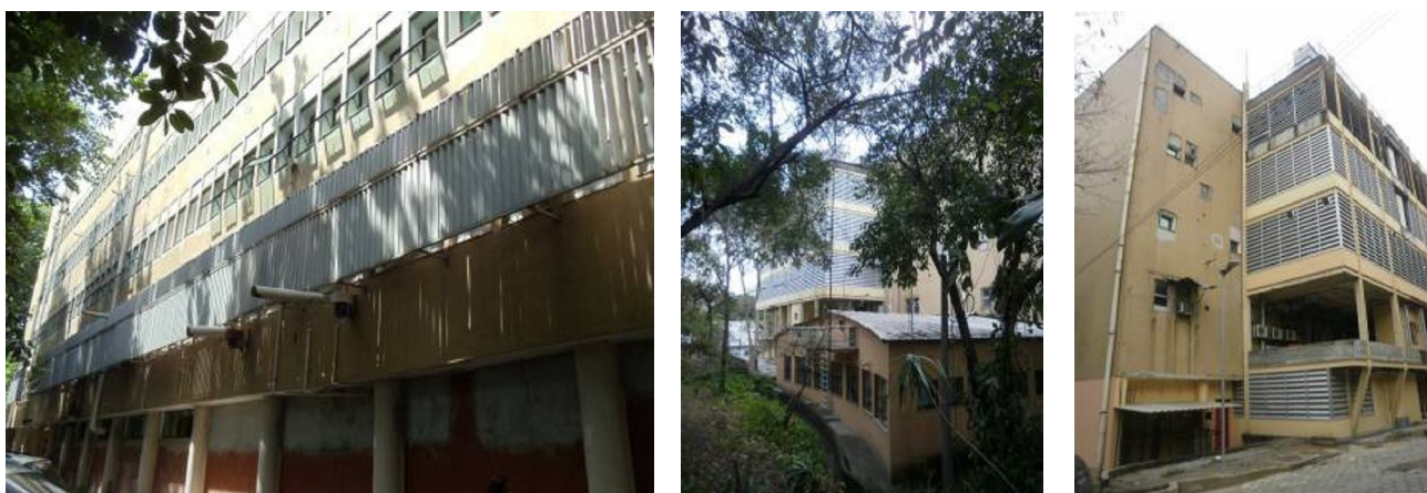
Acréscimos e descaracterizações no Pavilhão Carlos Chagas.
