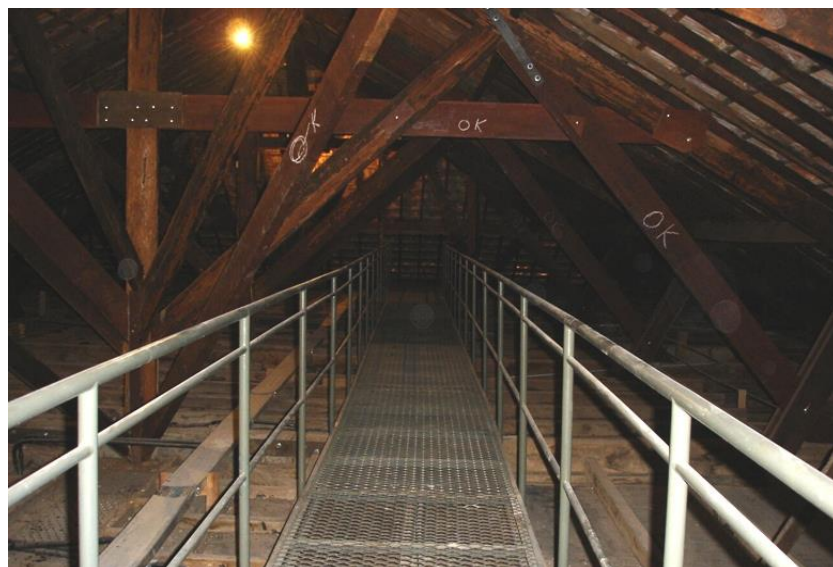
Figura 35: Passarela metálica instalada no entreferro do telhado. Fonte: DPH/COC (2007)
