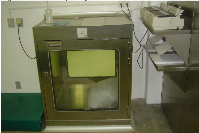
Figura 29. Caixa de passagem.
