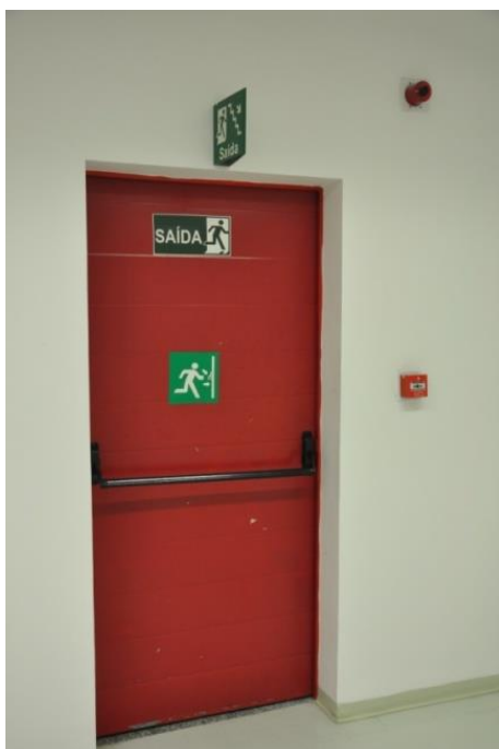
Figura 19. Porta de saída de emergência e alarme de incêndio.
