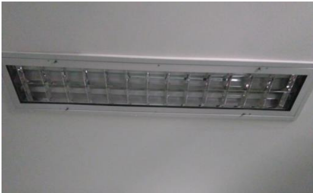
Figura 5. Luminária com proteção.
