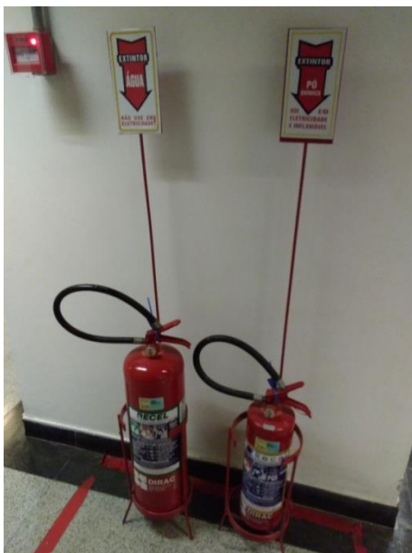
Figura 20. Extintores de incêndio.
