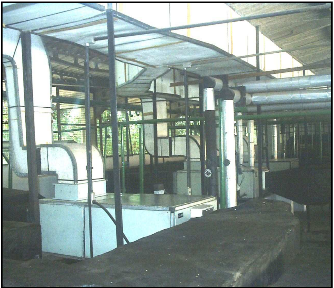
Foto 5.2 – Vista geral do piso técnico e sistema de condicionamento de ar
