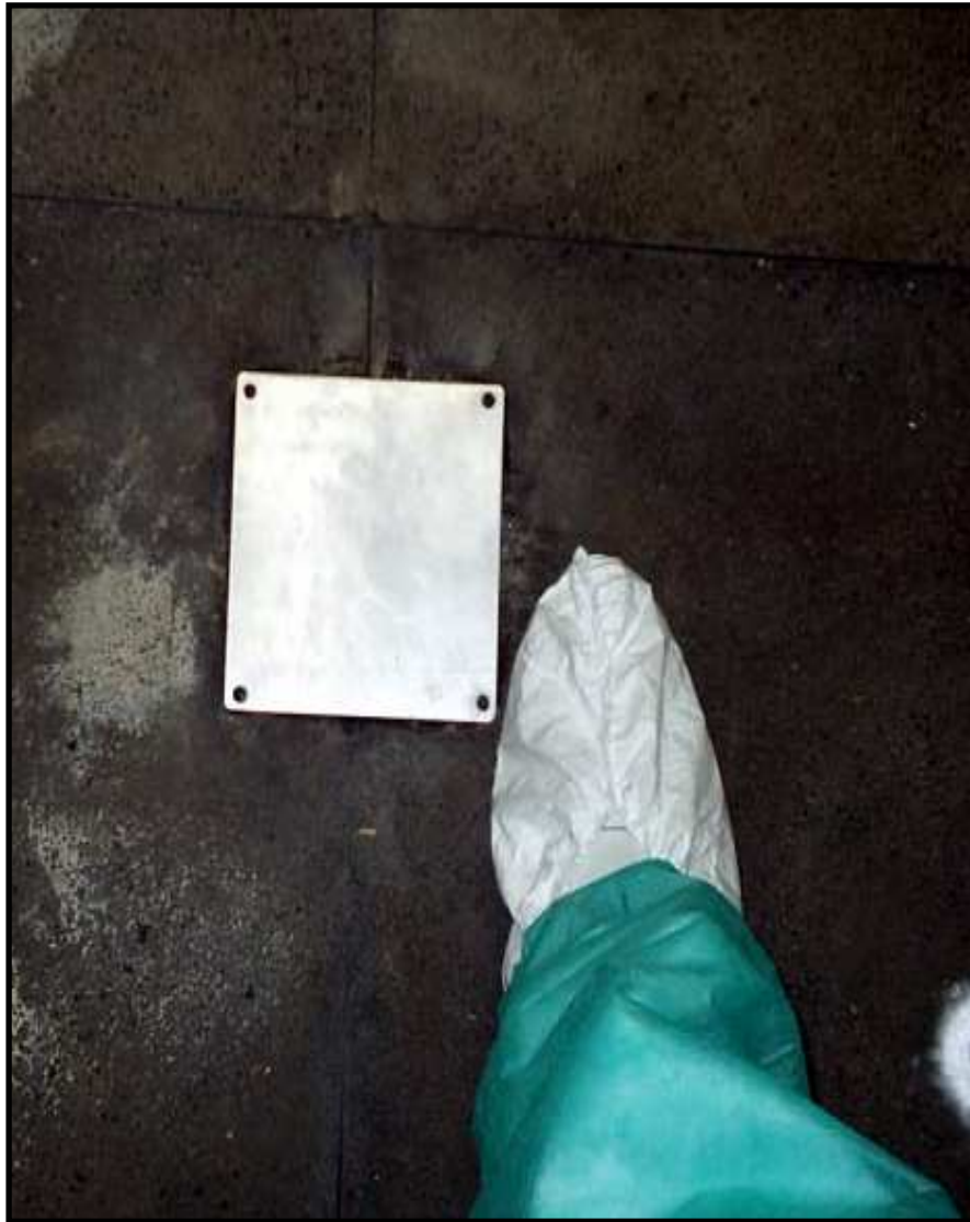
Foto 5.1 – Ralo tamponado com tampa cega em aço inoxidável, que visa eliminar o acesso de insetos e roedores por essa via à sala de animais.
