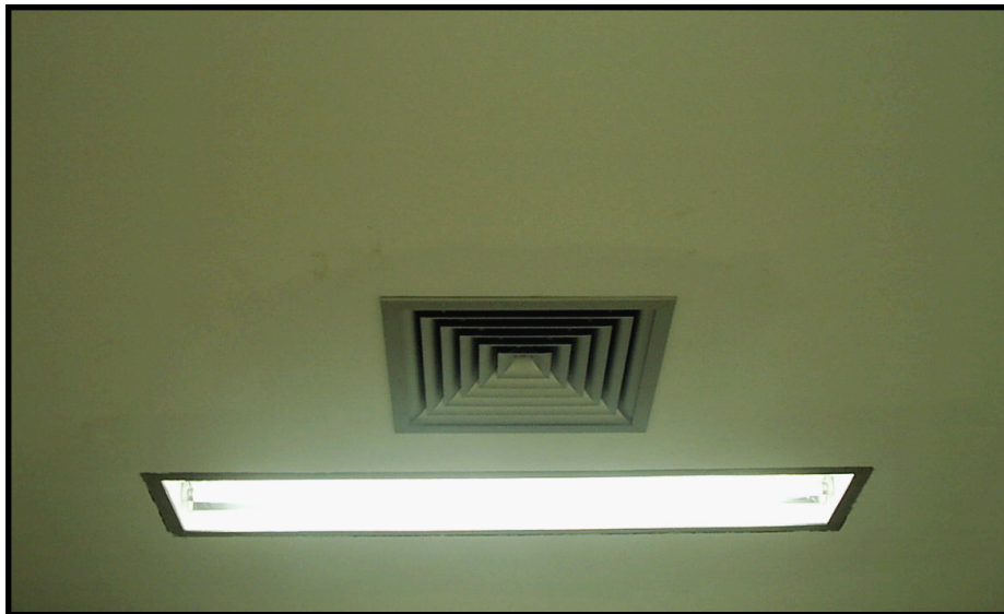
Foto 5.5 – Luminária e grelha de insuflamento de ar na sala de biossegurança animais 2 (NB-A2)
