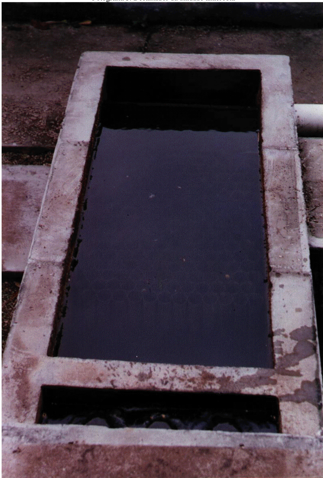
Fotografia 5. Decantador da unidade anaeróbia
