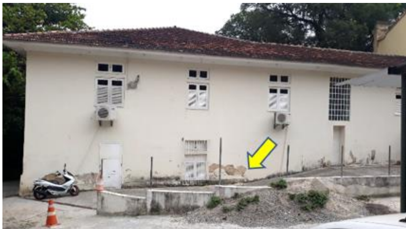
Figura 37 - Evidência de desprendimento do reboco na parte inferior da fachada dos fundos, em 2020.
