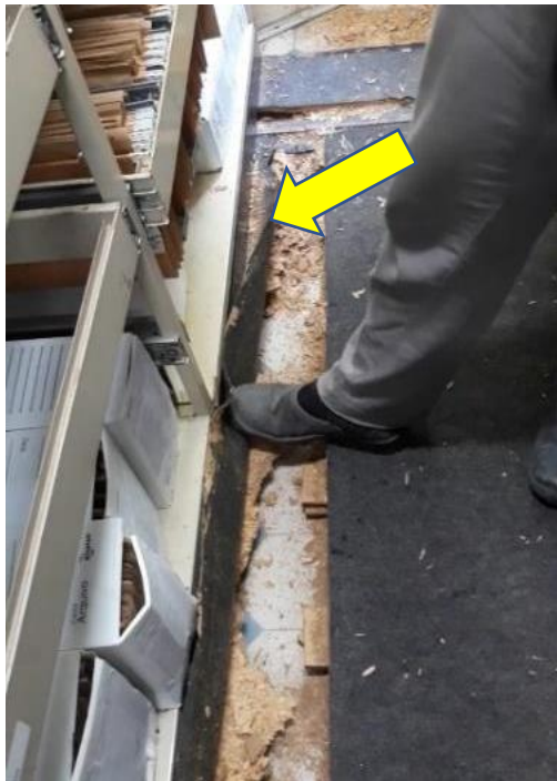
Figura 57 - Suporte de madeira deteriorado
