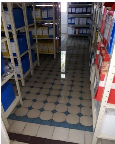
Figura 42 - Depósito do arquivo intermediário alagado, em dezembro de 2021.
