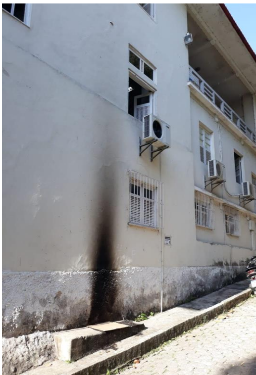
Figura 79 - Vestígios da ação de vandalismo na parte externa do edifício da Coordenação de Arquivos, em 2022.
