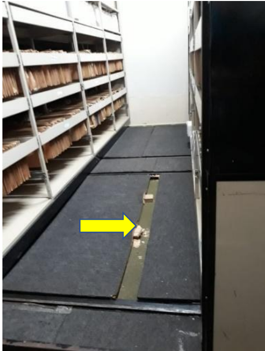
Figura 56 - Deslocamento do suporte de madeira.
