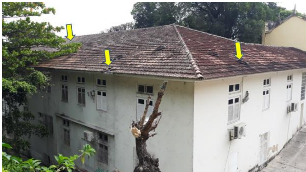
Figura 50 - Galho de árvore avançando sobre o telhado do edifício da Coordenação de Arquivos, buraco no telhado na direção do beiral e pneus de bicicleta que foram arremessados no telhado, em 2020.
