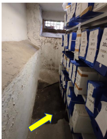
Figura 121 - Umidade ocasionada por ação de lençol freático, nos fundos do térreo do edifício, 2021.
