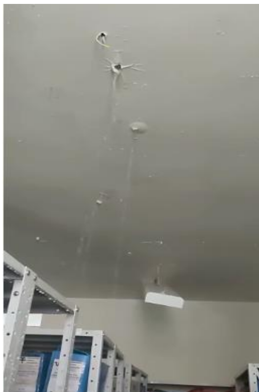
Figura 41 - Vazamento de água ocorrido pelo transbordamento da caixa d'água localizada na laje, em dezembro de 2021.
