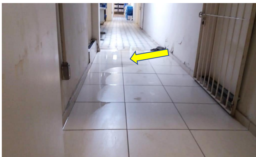
Figura 71 - Em dias de chuvas intensas, costuma-se formar poça de água, em 2019.
