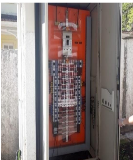
Figura 116 - Quadro geral de luz do edifício da Coordenação de Arquivos, em 2021.
