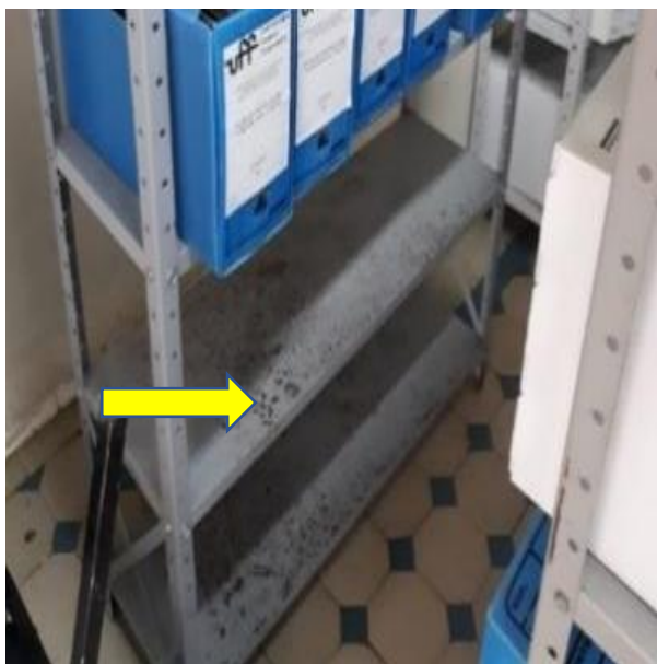
Figura 52 - Estante de aço com presença de ferrugem nas prateleiras.
