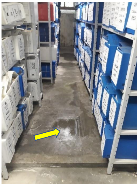
Figura 72 - Mina d'água causando poça de água em área de depósito do Arquivo de processos, em 2021.
