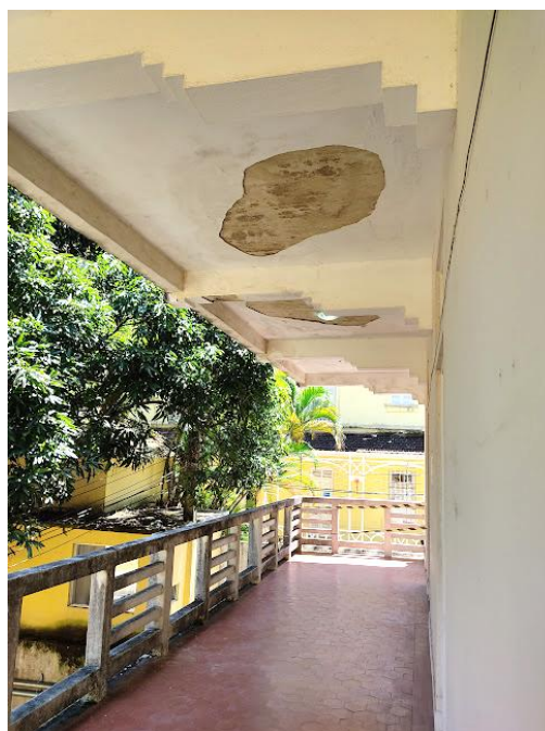
Figura 108 – Teto da varanda da fachada do 1º pavimento antes da reforma, de 2020 a 2021.
