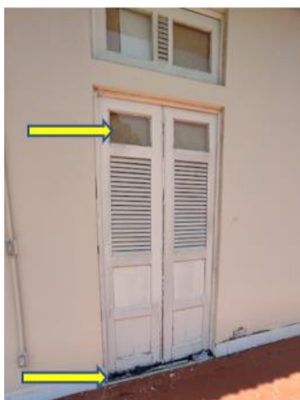
Figura 73 - Barreiras contra luz e vedação da fresta inferior da porta, em 2021.
