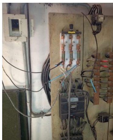
Figura 117 – Instalação elétrica antiga localizada na casa de força de energia, em 2020.
