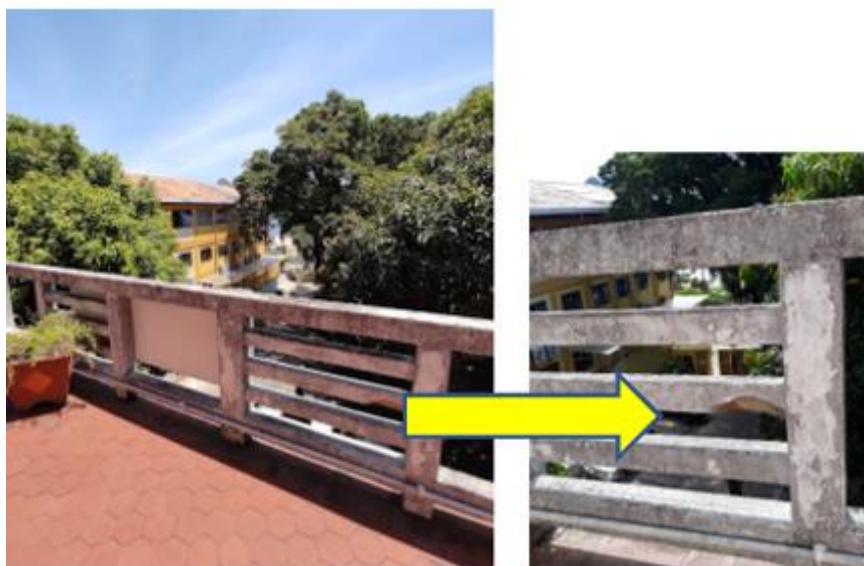
Figura 40 - Detalhe do descolamento de reboco dos parapeitos da varanda da fachada frontal do 2º pavimento, em 2021.
