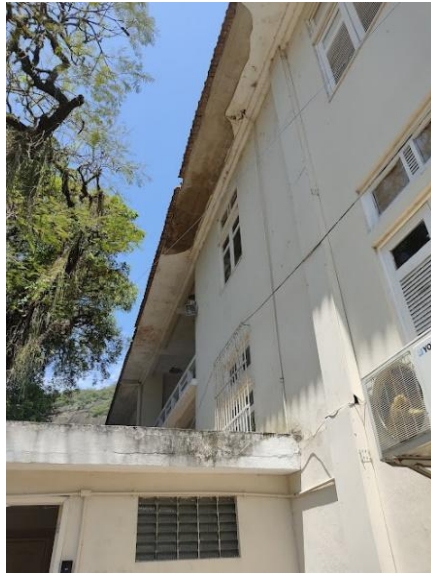
Figura 35 - Descolamento de reboco do beiral na área da entrada lateral do edifício da Coordenação de Arquivos, em 2021.
