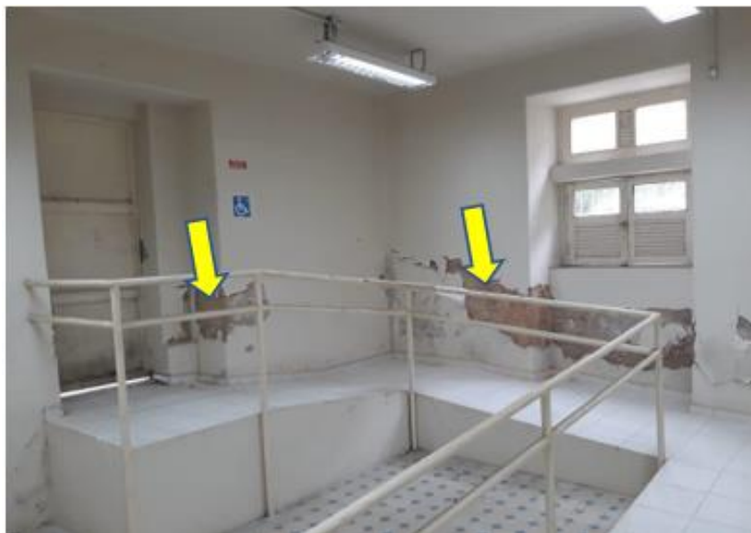
Figura 38 - Paredes localizadas nos fundos do 1º pavimento do edifício com descolamento de reboco agravado pela umidade do terreno, em 2021.
