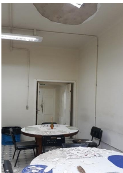
Figura 34 - Destroços da queda de reboco sobre as mesas na sala da copa do 2º pavimento, em 2019.
