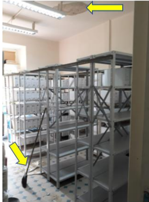
Figura 39 - Queda de reboco do teto no depósito de arquivo permanente, em 2022.
