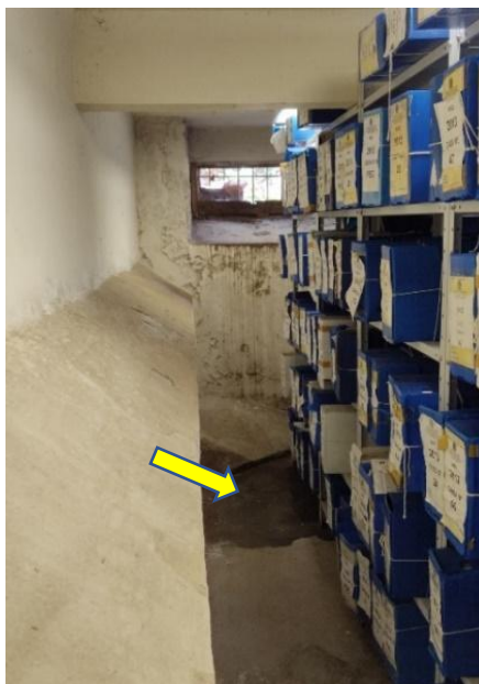
Figura 49 - Área de depósito do Arquivo de processos com constante umidade minando do chão e pequena entrada de ar na parede próxima às estantes.
