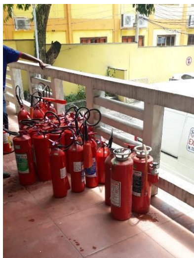
Figura 115 - Manutenção e recarga de extintores de incêndio do edifício da Coordenação de Arquivos, em 2021.
