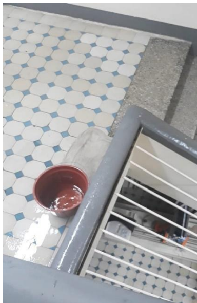
Figura 70 - Ocorrência de goteiras no edifício em dias de chuvas, dezembro de 2020.
