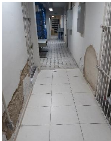
Figura 110 - Manutenção corretiva nos fundos do térreo do edifício: Emboço refeito, sem acabamento, em 2021.
