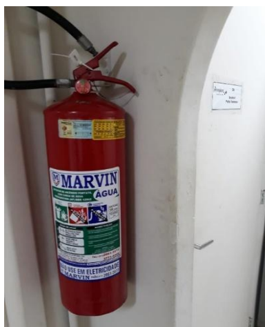
Figura 75 - Extintor água indicado para combate ao incêndio em produtos como papel.
