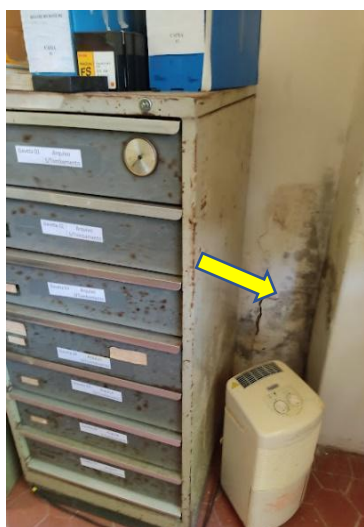
Figura 47 - Presença de umidade e mofo na sala de guarda de microfilmes, em 2021.
