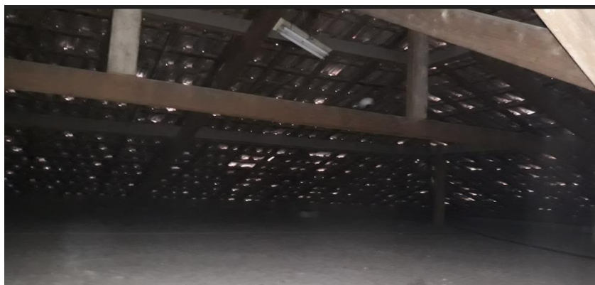
Figura 33 - Telhado do edifício da Coordenação de Arquivos com falhas nas telhas francesas por onde infiltra a água da chuva, em 2021.
