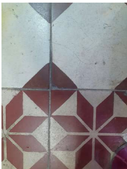
Figura 56 - Substituição equivocada de piso faltante por outro modelo – Casa Chic
