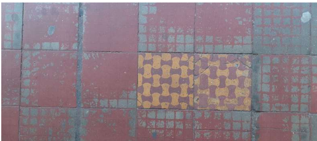
Figura 61 - Resquício de ladrilhos hidráulicos no passeio da rua Marechal Deodoro.
