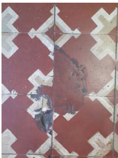
Figura 54 - Enxerto de cimento coberto de cera para preencher lacuna da peça – Ferragens Fernandes.
