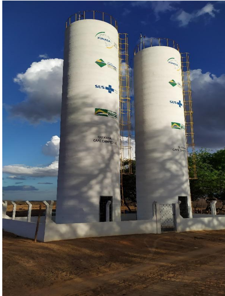
Fotografia 4 – Torres de tratamento e reservação do SAA
