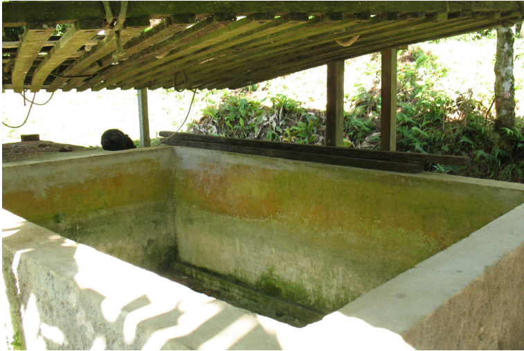
g) Piscina para choque térmico.
