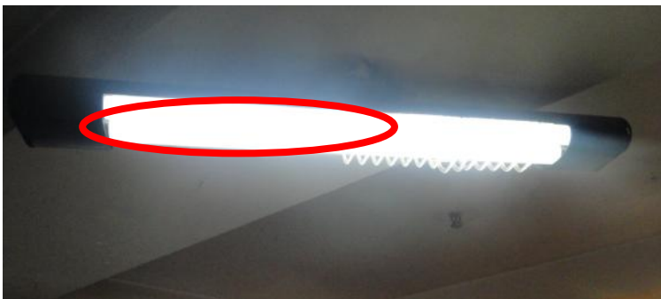
Figura 2- Luminária sem proteção contra quebra e explosão
