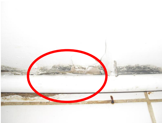
Figura 6- Parede com revestimento danificado (descascando)
