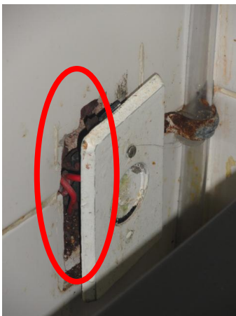
Figura 7- Espelho do interruptor não fixado na parede
