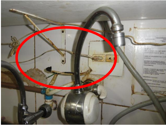
Figura 3: Instalações elétricas aparentes e azulejo quebrado
