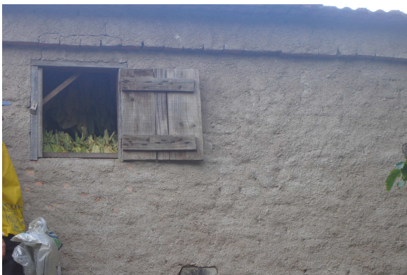
Figura 9: Aberturas superiores da estufa que auxiliam no controle da umidade, Rincão dos Maia, Canguçu, RS.
