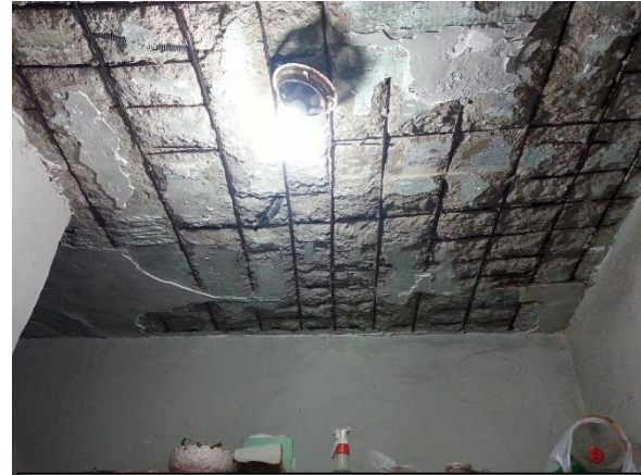
Figura 4.3 Teto da cozinha interditada pela Defesa Civil em 2014; ainda em uso. Fonte: Própria.
