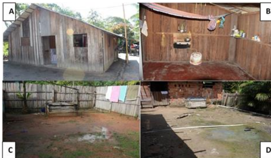
Figura 30 – Habitações precárias do distrito do Murinin, Benevides, Pará. A e B) casas com teto baixo e janelas inadequadas, quartos com duas ou mais funções; C e D) com semi-alagamento e contaminação do solo. Fonte: Do autor.
