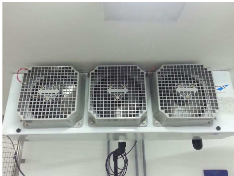
Figura 4-4 Saída de ar refrigerado da sala de freezer .
