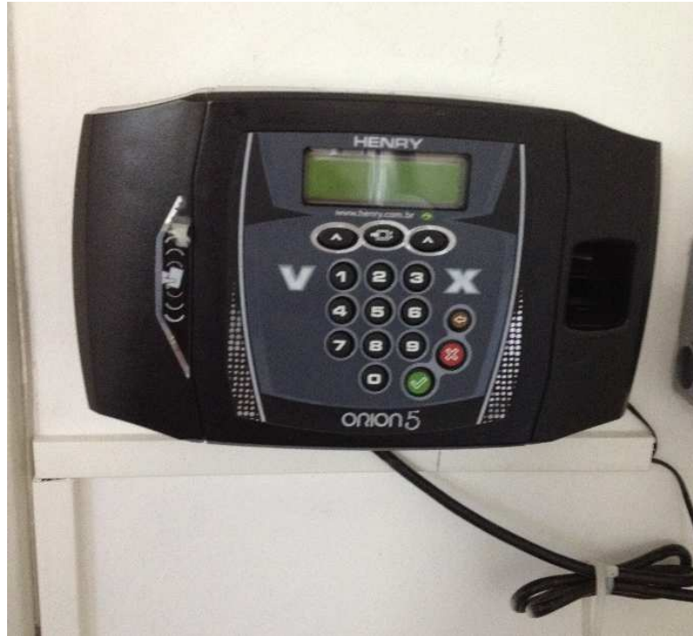
Figura 4-6 Equipamento que controla o acesso à sala de freezers .
