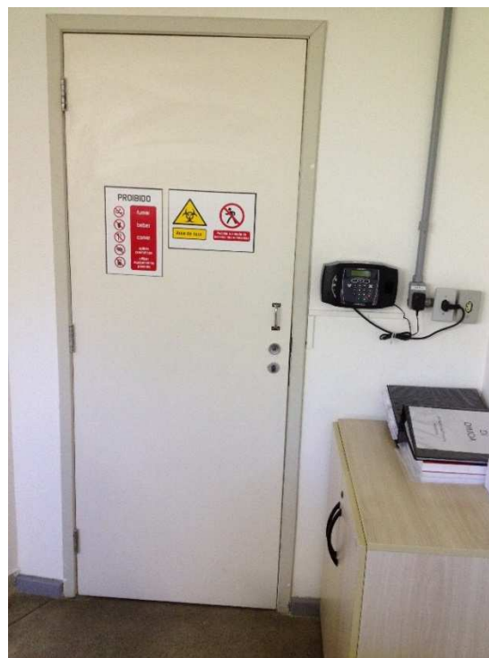
Figura 4-7 Vista ampliada do controle de acesso à sala de freezers .
