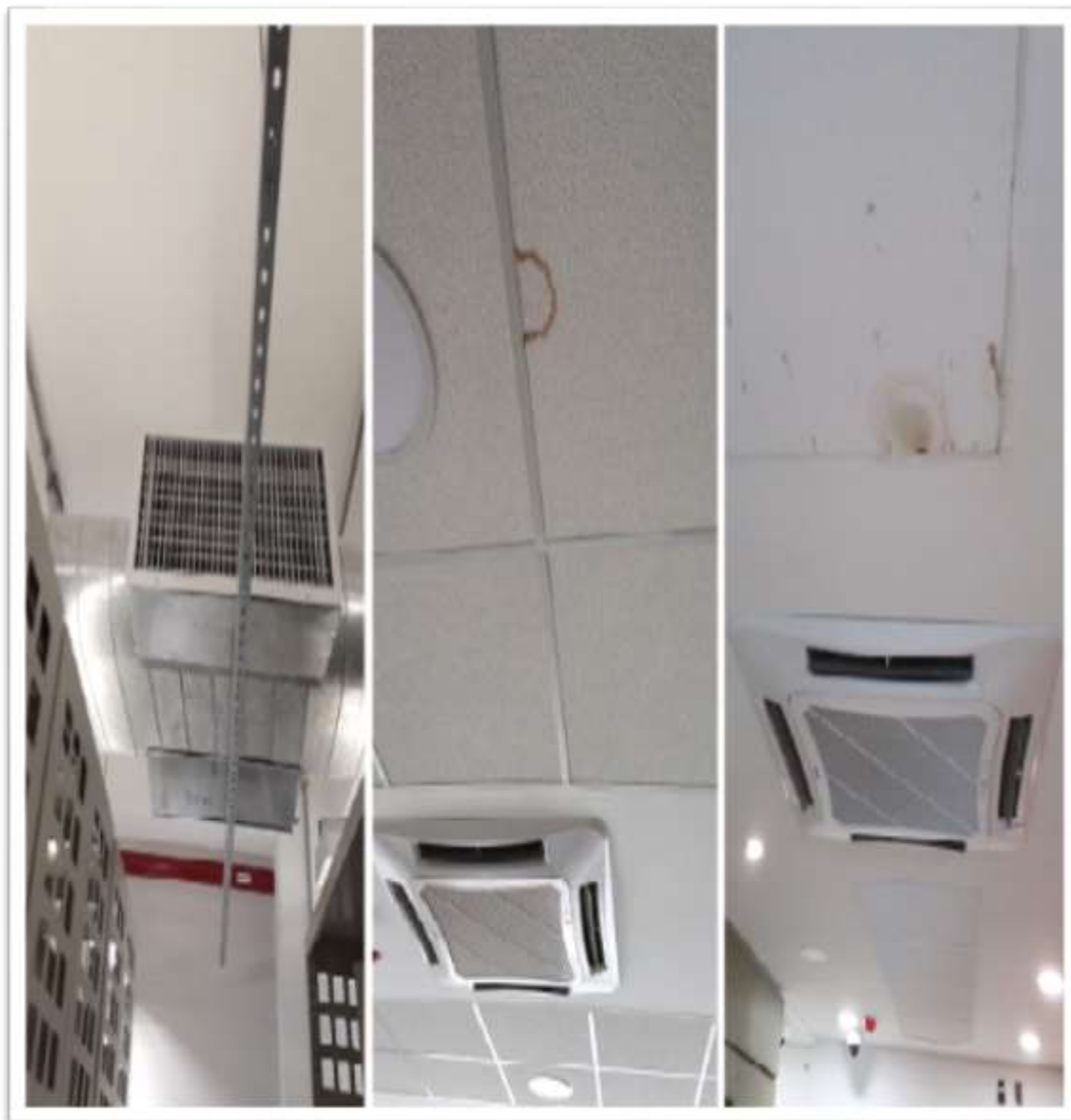
Figura 35 – Marcas de molhamento do ar condicionado no hall de elevadores no andar térreo
