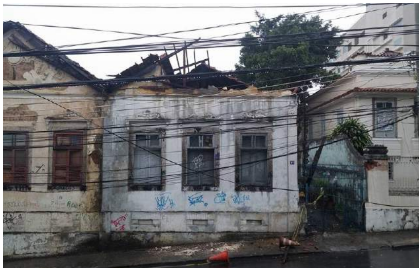
Figura 65 - Imóvel de 1886, localizado na Rua Coronel Cabrita 47 e 49, em São Cristóvão, Rio de Janeiro, novembro de 2015 24 .
