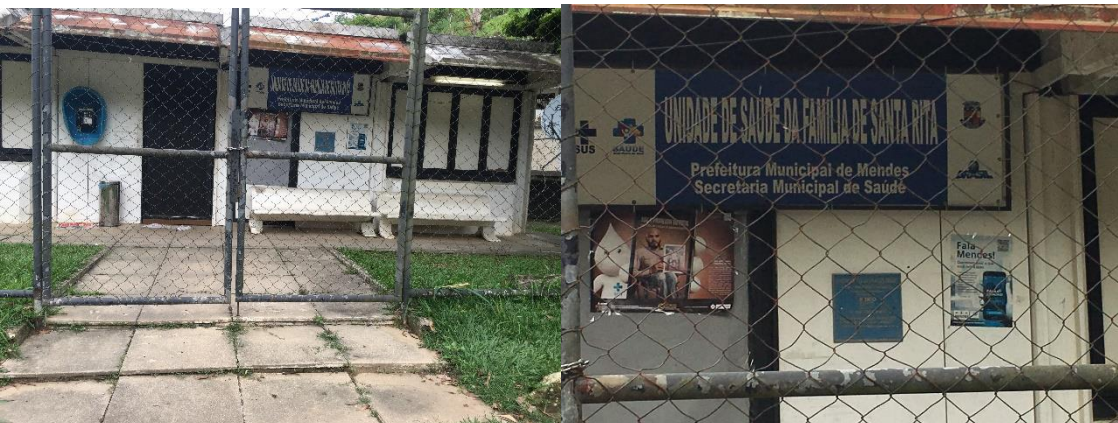
FOTO 2: PSF SEM RAMPA
