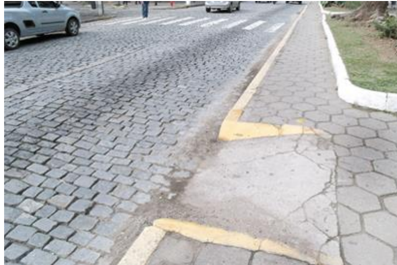
Imagem 5: Rampa de acesso longe da faixa de pedestres, com inclinação errada, rachaduras, buracos e desníveis. (arquivo pessoal)
