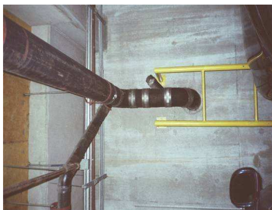
Figura 123: Poço de captação do esgoto sanitário no subsolo
