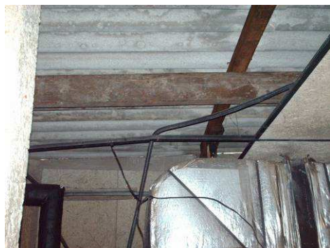
Figura 51: Sala do fan-coil sem forro
