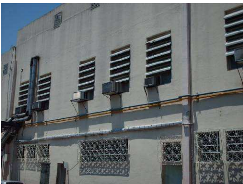
Figura 66: Aparelhos de ar condicionado individuais nas salas de cirurgia
