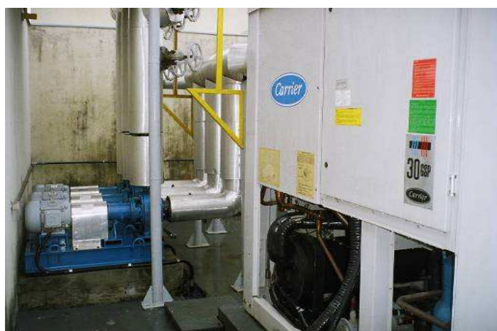
Figura 12: Central de ar condicionado 1
