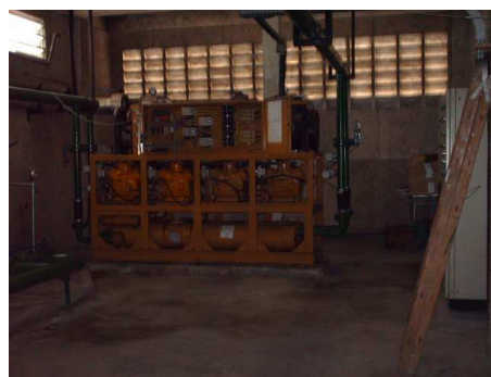
Figura 04: Central de ar condicionado 2
