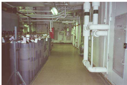
Figura 19: Central de ar condicionado
