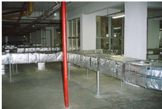
Figura 83: Rede de dutos sem acesso
