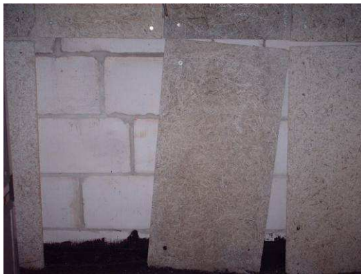
Figura 52: Sala do fan-coil com parede sem revestimento
