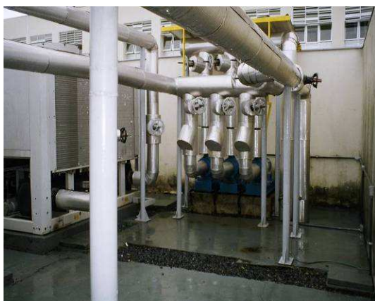
Figura 77: Central de ar condicionado
