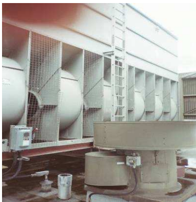
Figura 121: Torre de arrefecimento na cobertura
