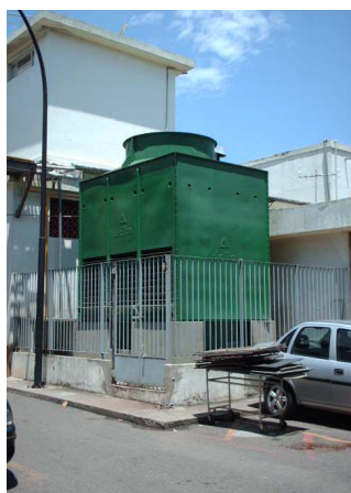
Figura 03: Central de ar condicionado 1
