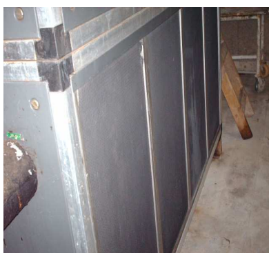
Figura 02: Sala do fan-coil
