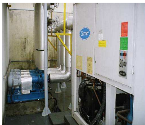
Figura 78: Central de ar condicionado
