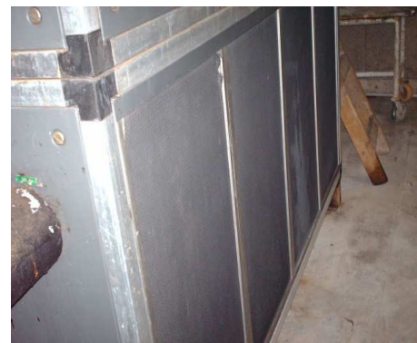
Figura 65: Sala do fan-coil da imagenologia
