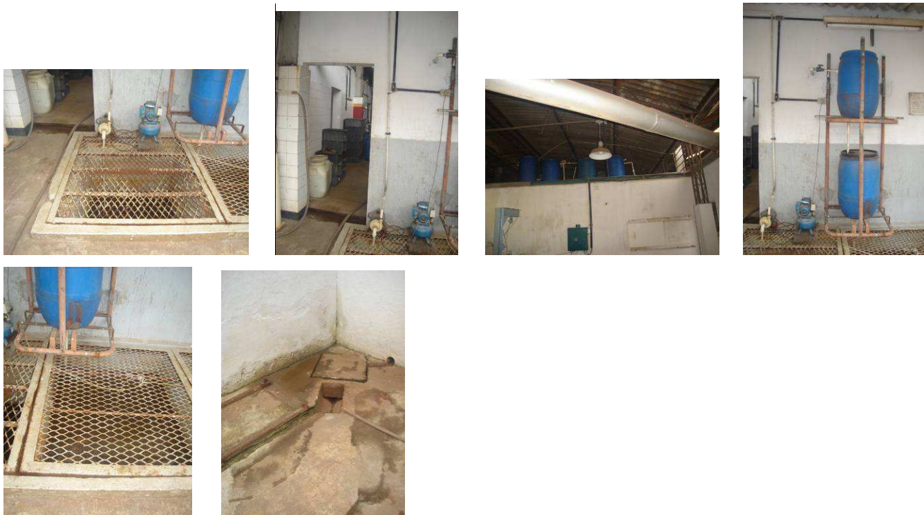
Figura 53: Estágios de tratamento: tanque, tanque 2 e 3, bombonas, duto, tanque e rede de esgoto sanitário (meio ambiente).
