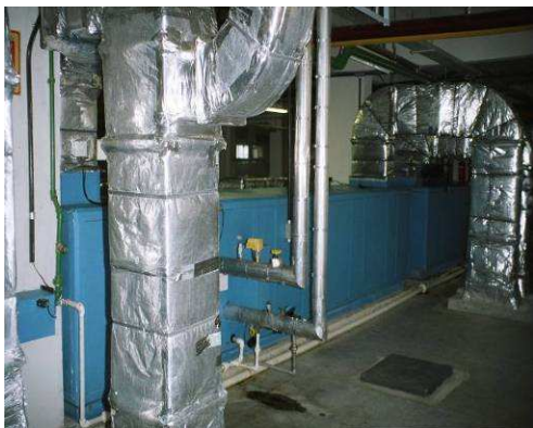
Figura 84: Fan-coil e dutos
