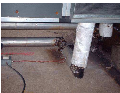
Figura 50: Tubulação sem revestimento térmico
