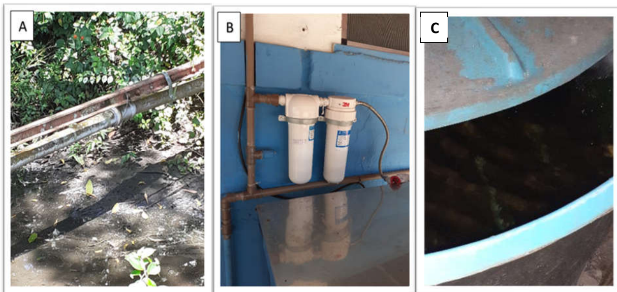
Figura 14 - Cruzamento da rede de distribuição com canal, filtros dos bebedouros e sedimentos no fundo da caixa d'água. Em (A) O cruzamento da rede distribuição com canal poluído; (B) Filtros usados nos bebedouros do Rancho e; (C) Caixa d'água do rancho com acúmulo de sedimentos no fundo.
