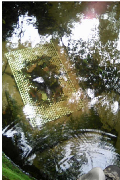
Figura 7 - Gradeamento na tomada d'água.
