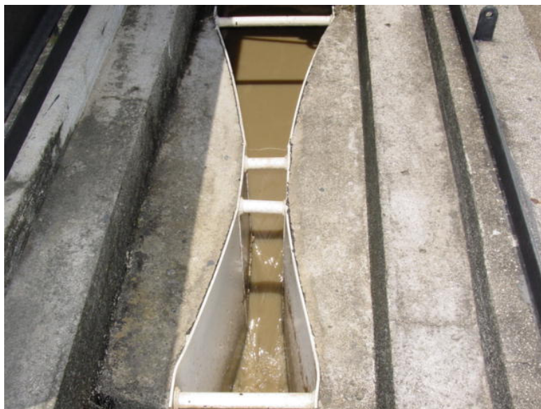
Figura 4.2 - Calha Parshal da estação do empreendimento A.
