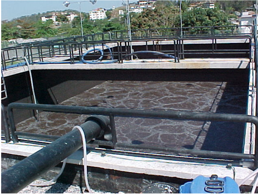
Figura 4.5 - Tanque de aeração da estação de tratamento de esgotos do empreendimento C.
