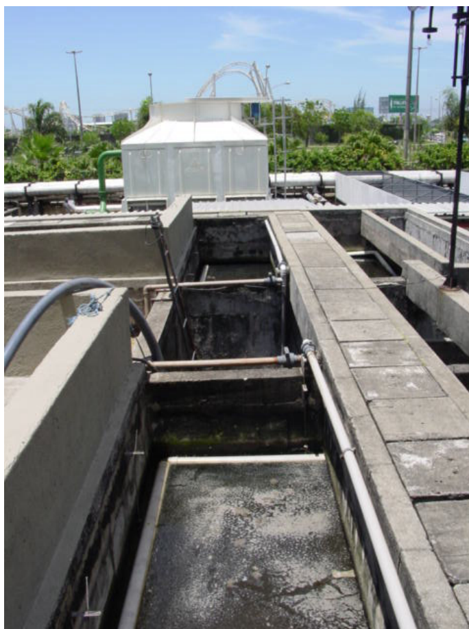
Figura 4.3 - Tanques de lodo da estação do empreendimento A.
