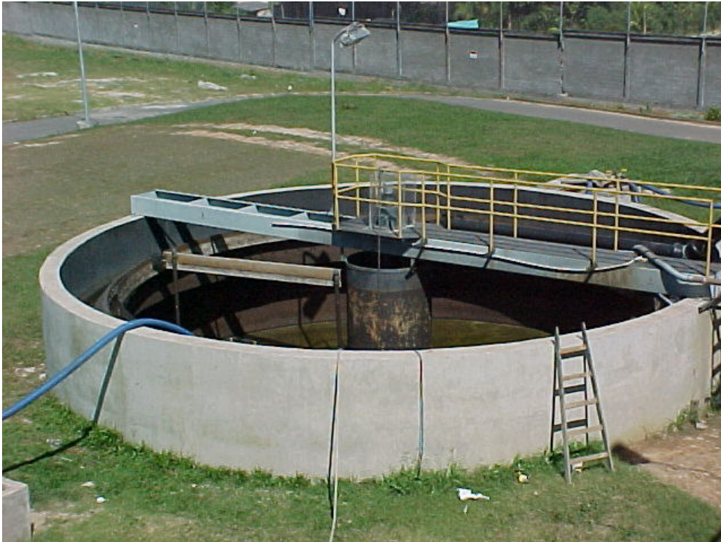
Figura 4.7 – Decantador secundário da estação do empreendimento C.
