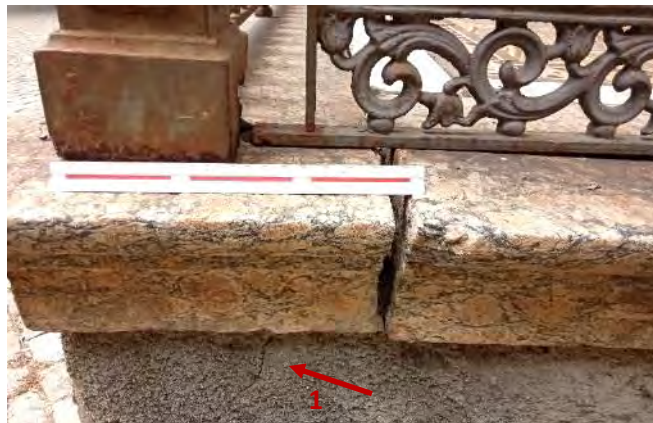
Figura 106: Progressão do dano em outubro de 2019. Observa-se também o início de uma fissura na superfície da alvenaria da base (1), não observada em 1999 e em 2012, e o avanço da oxidação dos elementos de ferro fundido. Fonte: Camila Ennes.
