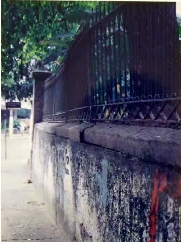
Figura 107: Dano em muro de alvenaria de pedra no perímetro do conjunto, observado em 1999, decorrente, provavelmente, do aterramento da área interna, realizado de maneira a utilizá-lo como arrimo, sem que tenha sido projetado para tal, além da proximidade com as raízes das árvores. Fonte: Mello (1999)
