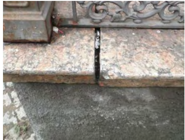
Figura 105: Dano decorrente de recalque na fundação na varanda do Chalé, identificado em 2012 em Relatório da Acrópole para Etapa I do Projeto de Restauração. Fonte: Acrópole (2012).
