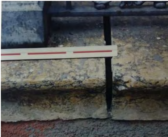
Figura 104: Dano decorrente de recalque na fundação na varanda do Chalé, identificado em 1999. Fonte: Mello (1999).
