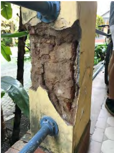
Figura 152: Prospecção realizada em 2019 nos pilares da varanda do primeiro pavimento, revelando a estrutura em tijolos maciços. Fonte: Professor Ronaldo Brillhante, 2019.
