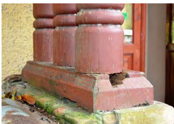
Figura 185: Base das colunas danificada antes de intervenções (novembro de 2017). Fonte: Camila Ennes.
