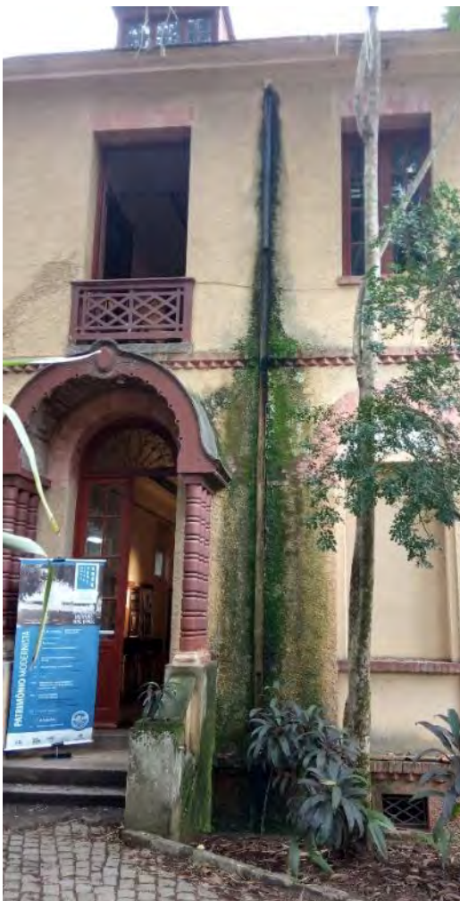
Figura 99: Danos identificados na fachada Sudoeste devido à perda de parte do condutor vertical de águas pluviais em 1999. Fonte: Mello (1999).
