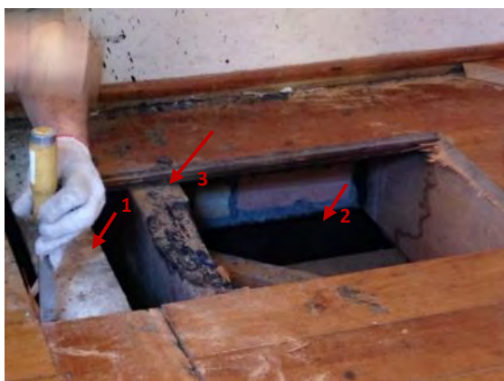
Figura 149: Área do piso da Sala 11 afetada pelo incêndio. Pode-se visualizar o topo da viga metálica paralela ao barroteamento (1), o topo do barrote danificado pelo incêndio (3) e a viga metálica transversal, sob parede de alvenaria de tijolos, sobre a qual se apoia a primeira e os barrotes.
