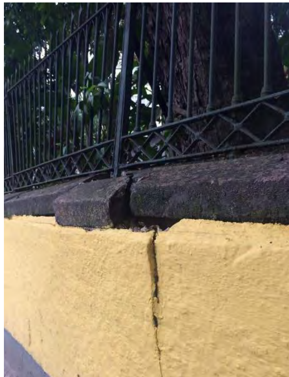
Figura 109: Progressão do dano observada em dezembro de 2018. Observa-se que a cantaria se encontra com um deslocamento maior, a alvenaria abaixo começou a romper-se e o gradil apresenta maior deformação. Fonte: Jonatas Chaves.
