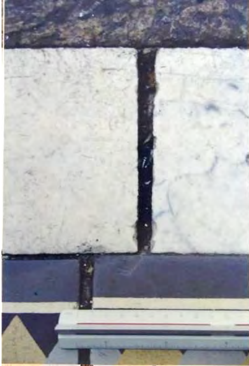
Figura 102: Dano decorrente de recalque na fundação na varanda do Chalé, identificado em 1999. Fonte: Mello (1999).
