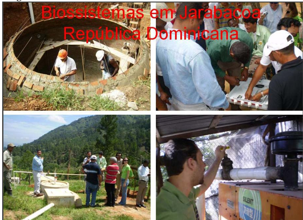
FIGURA 30: Construção de Biossistema Integrado em Jarabacoa na República Dominicana com Produção de Energia a partir de Motor a Biogás
