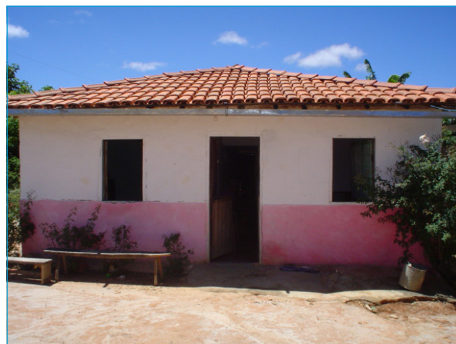
Figura 4 - Domicílio com boa condição estrutural e do telhado. Município de Minas Novas, Vale do Jequitinhonha.
