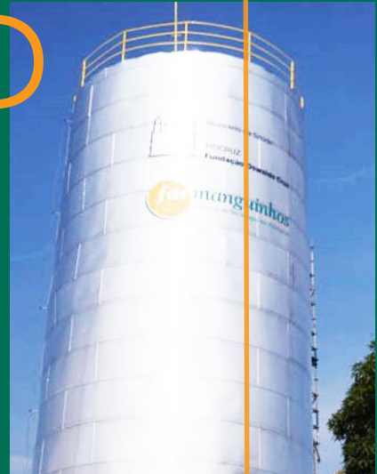
Termoacumulador contribui para redução de custos em Farmanguinhos
