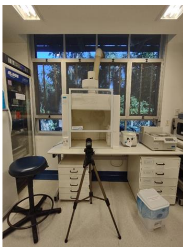
Foto 11 - Medições de NPS na Capela de Exaustão de Gases SPLABOR, modelo SP-80, na Sala
