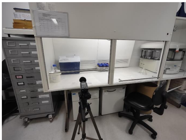
Foto 16 - Medições de NPS nas Capela de Exaustão de Gases na Sala 16.
