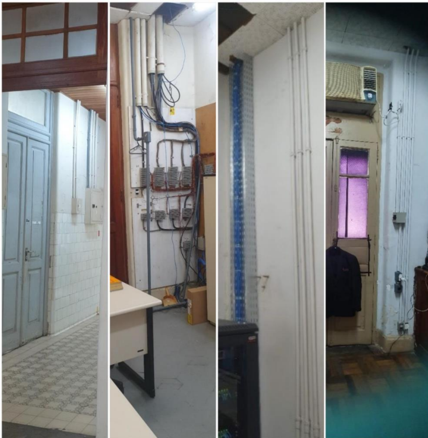
Figura 90: Exemplos de ambientes com instalações prediais inadequadas e que descaracterizam o interior e esquadrias com instalação de aparelho de ar condicionado na bandeira Fonte: A autora, 2022.
