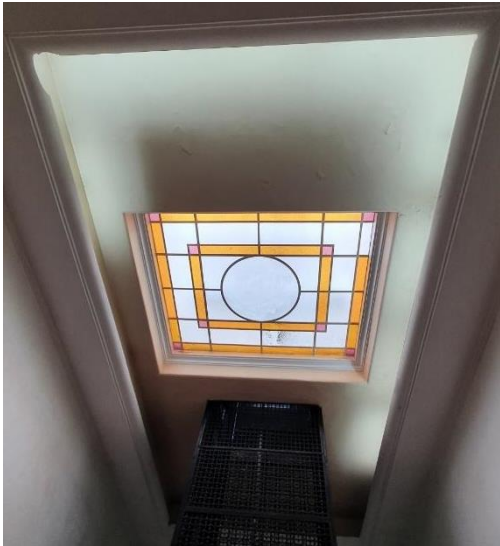
Figura 70: Claraboia em vidro colorido, sendo elemento de cobertura e melhora na incidência de iluminação natural no ambiente. Fonte: A autora, 2022.
