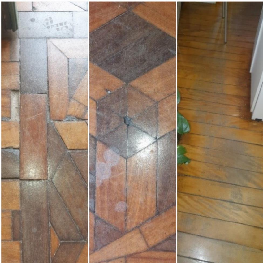
Figura 88: Pisos tipo parquet e tabuado danificados, por ação mecânica, falta de conservação e intervenções inadequadas. Fonte: A autora, 2022.
