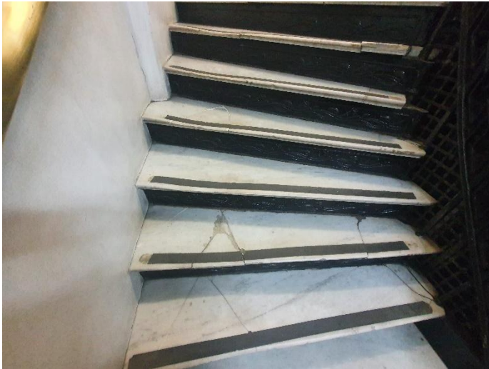
Figura 83: A escada principal do DGSP apresenta pedras quebradas, rachadas e desgaste devido a ação mecânica. Fonte: A autora, 2022.
