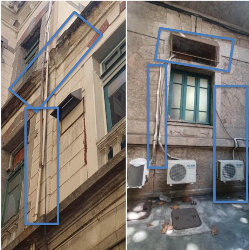
Figura 97: Fachada interna e lateral, com instalações aparentes, elementos que descaracterizam a fachada. Fonte: A autora, 2022.
