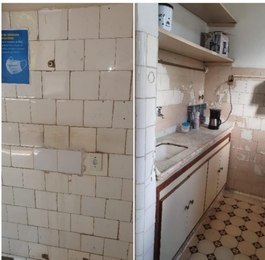
Figura 86: Corredor e copa revestidos em azulejo. Apresentam furos, rejuntamento danificado, sujeira, uso de material inadequado em substituição de peças e pintura em mau estado sobre azulejo. Fonte: A autora, 2022.
