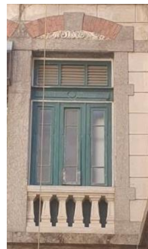
Figura 62: Porta da sacada em madeira com fechamento, bandeiras e venezianas em vidro. Fonte: A autora, 2022.
