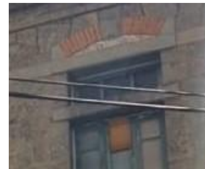
Figura 102: Vidros faltantes. Fonte: A autora, 2022.
