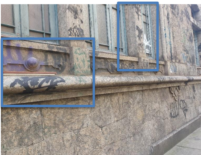
Figura 96: Presença de pichações na fachada principal Fonte: A autora, 2022.
