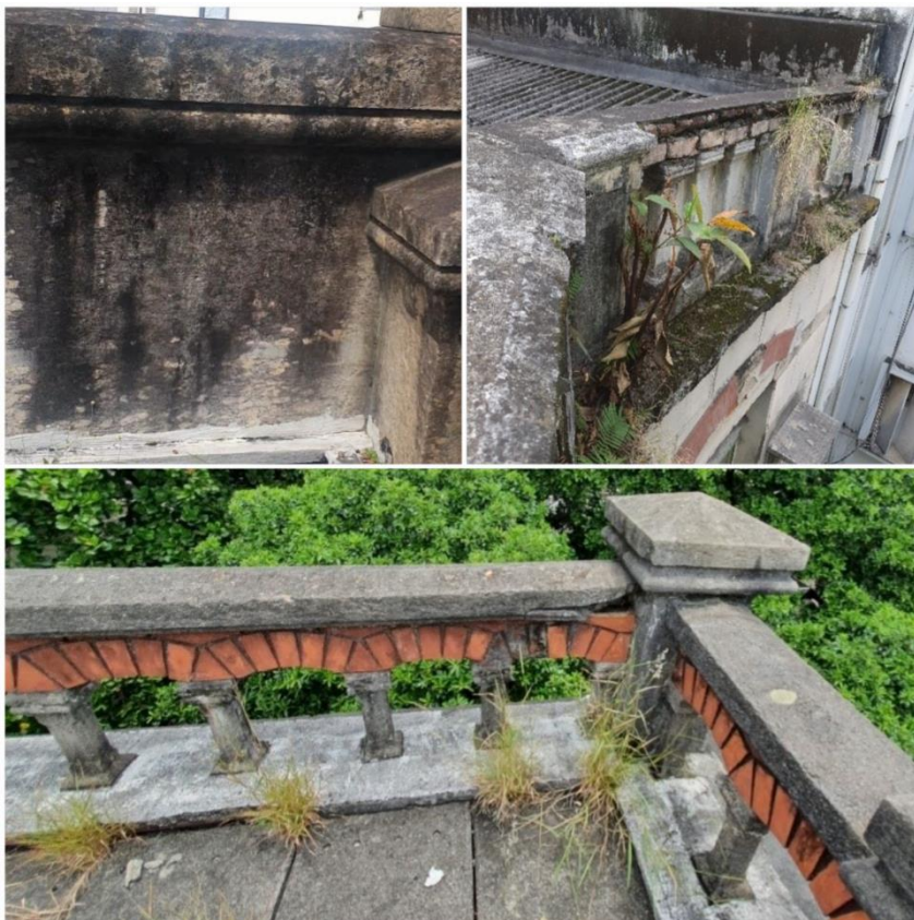
Figura 93: Balastrada do terraço com manchas escuras, revestimentos faltantes, presença de fezes de insetos e vegetação. Fonte: A autora, 2022.
