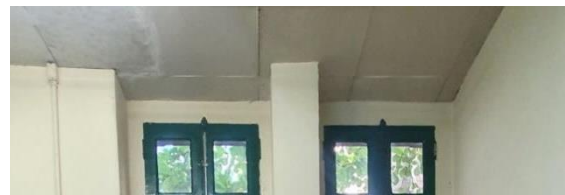
Figura 58: Forro em gesso placa 60 x 60 cm. Fonte: A autora, 2022.
