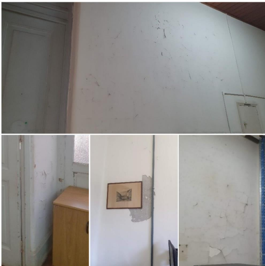
Figura 85: Exemplos de paredes no edifício histórico, com revestimento em pintura, que apresenta áreas de reboco descolando em placas e descascando. Fonte: A autora, 2022.
