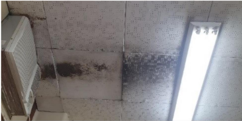
Figura 87: Sala com cobertura em laje com presença de infiltração, mofo e deterioração do material construtivo falta de conservação e intervenções inadequadas. Outra sala com forro de Eucatex em regular estado de conservação com presença de sujeira e manchas de umidade. Fonte: A autora, 2022.
