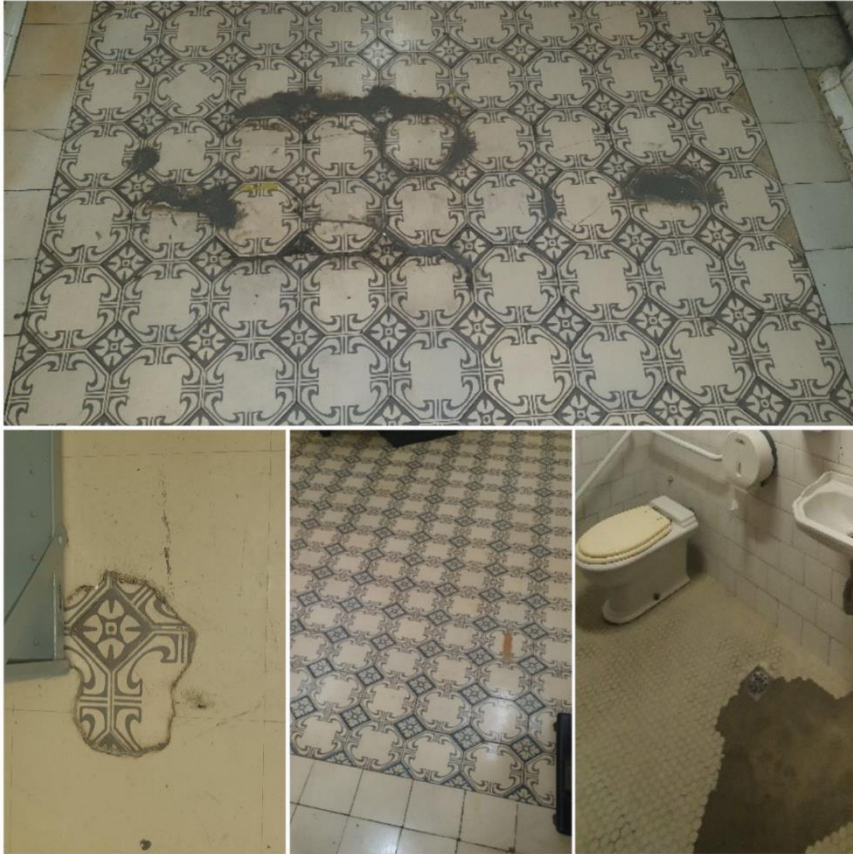
Figura 89: Pisos em ladrilho hidráulicos danificados, por ação mecânica e intervenções inadequadas. Fonte: A autora, 2022.
