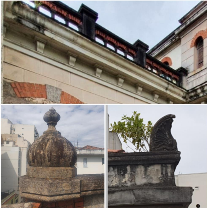
Figura 45: Balastrada no terraço decorada com tijolos de Marselha e elementos decorativos acima da platibanda. Fonte: A autora, 2022
