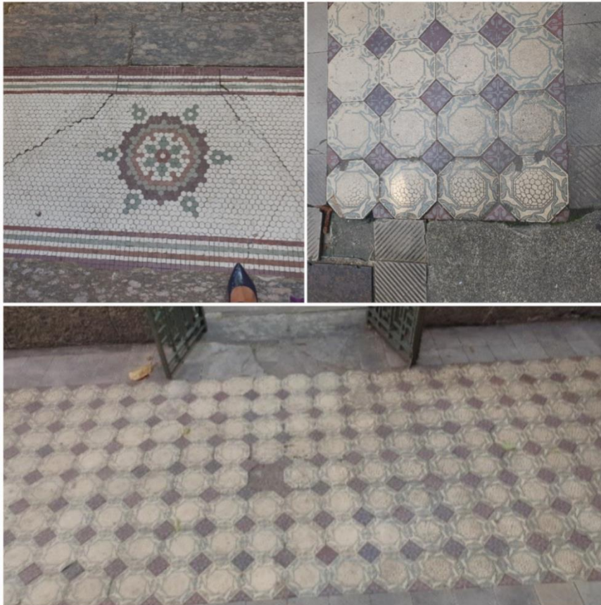
Figura 92: Entrada do DGSP, com presença de ladrilhos hidráulicos quebrados, com rachaduras, desgaste ou peças faltantes. Fonte: A autora, 2022.
