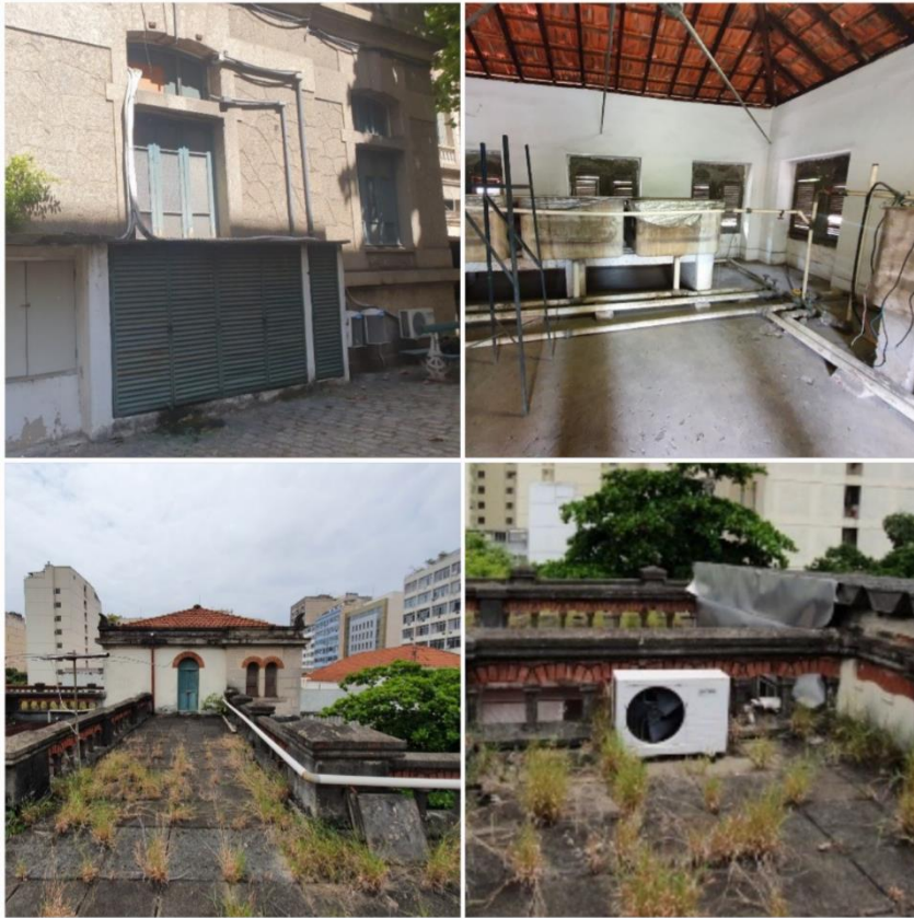
Figura 94: Exemplos de parte da fachada direita e terraço com a presença de instalações prediais inadequadas e que descaracterizam o exterior. Fonte: A autora, 2022.
