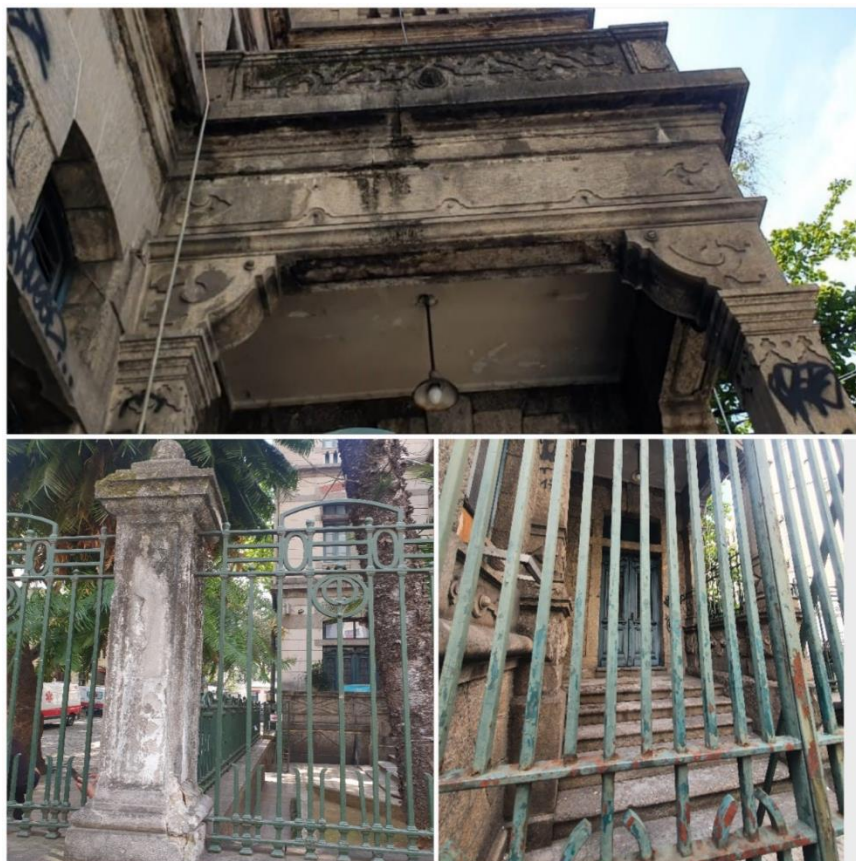
Figura 91: Fachada a antiga entrada do DGSP, com sujidades, mancha de umidade e pilações nas paredes, revestimento do teto descascando. Elemento do muro em deterioração, com presença de cobertura biológica e gradil com presença de ferrugem.
