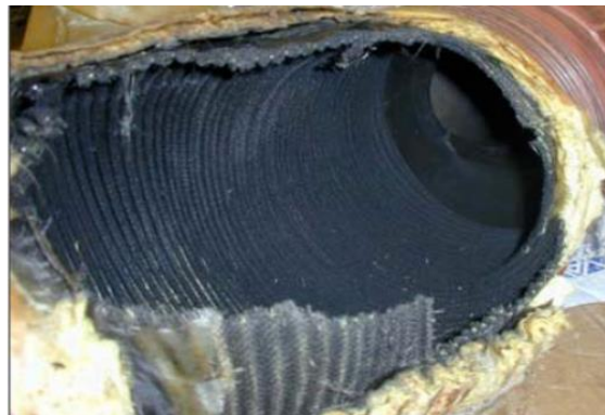
Figura 7: Duto usado de ar-condicionado da aeronave BAe 146, com mais de 25.000 horas de utilização
