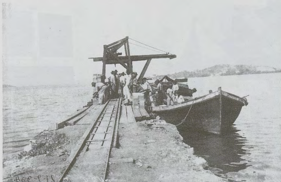
A primitiva ponte de acesso ao Instituto, no começo das obras em 1903
